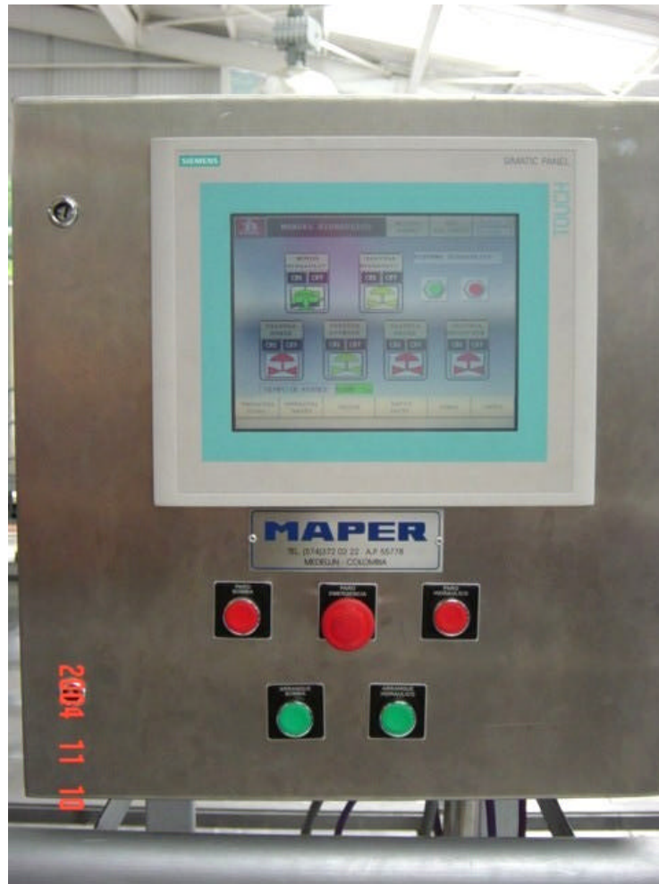
Figura 7. Consola Touchscreen Pasteurizadora
