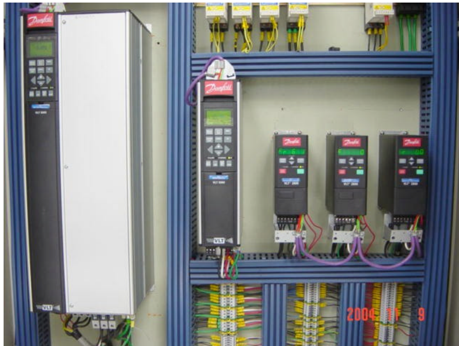
Figura 9. Variadores de Velocidad
