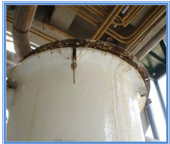
FOTO 2 DETALLE CONDICIÓN DE DETERIORO DE SUPERFICIE EN LA CABEZA SUPERIOR.
