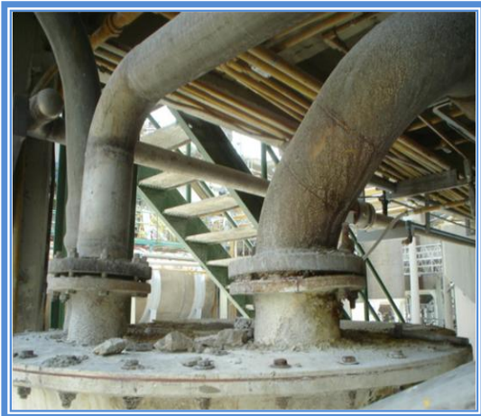
FOTO 1 DETALLE ESTADO DE DETERIORO TOBERAS Y BRIDAS CABEZA SUPERIOR
