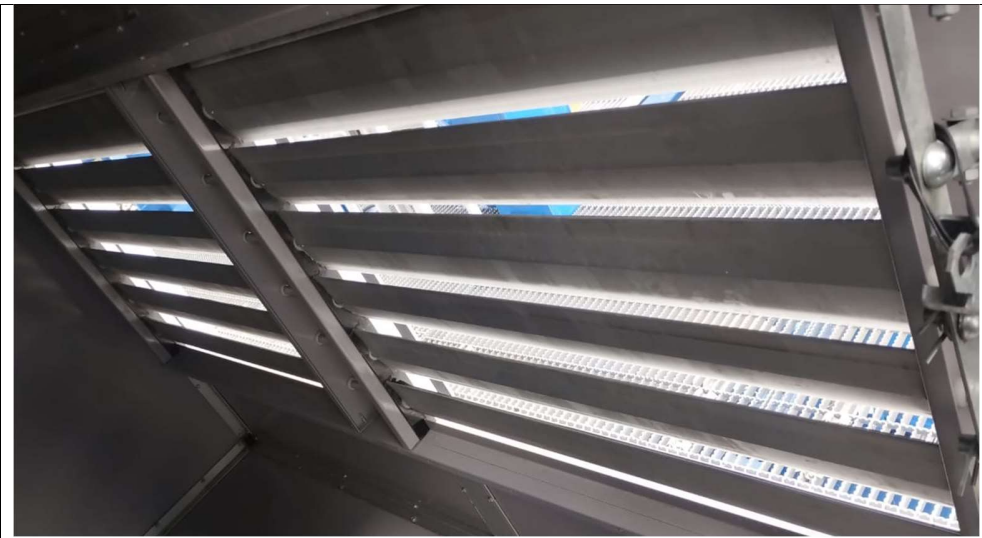
TOMA DE AIRE FRESCO DE LA UNIDAD MANEJADORA DE AIRE EN LA CAJA DE MEZCLA
