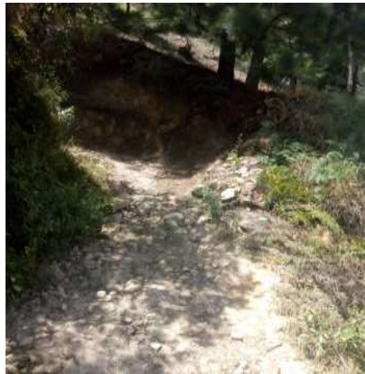
Figura 26. Presencia de vegetación en la corona del talud
