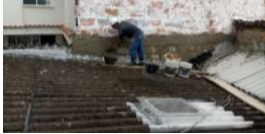
Figura 51. Mantenimiento en exteriores.
