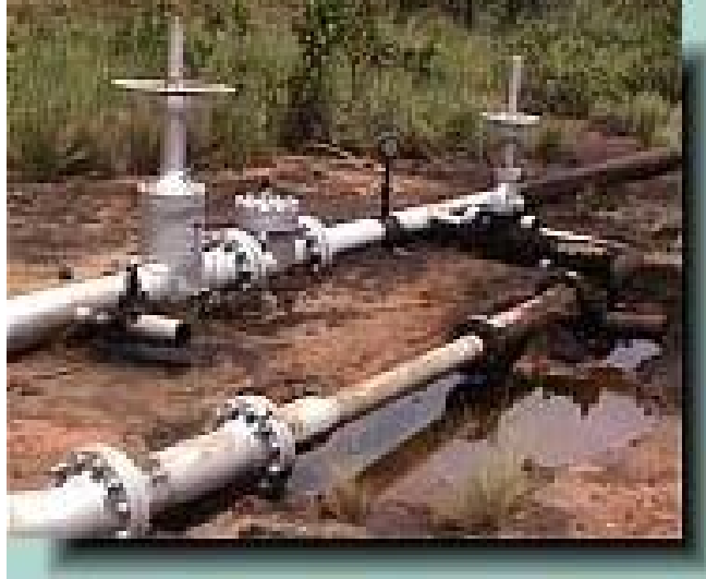
Figura 72. Fuga en válvulas o juntas corroidas
