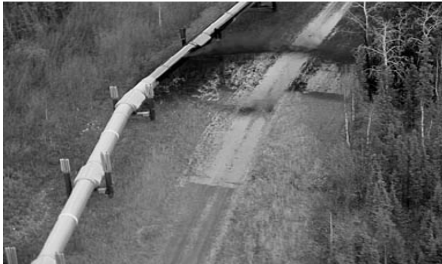
Figura 4. Pequeñas fugas o escapes en oleoductos
