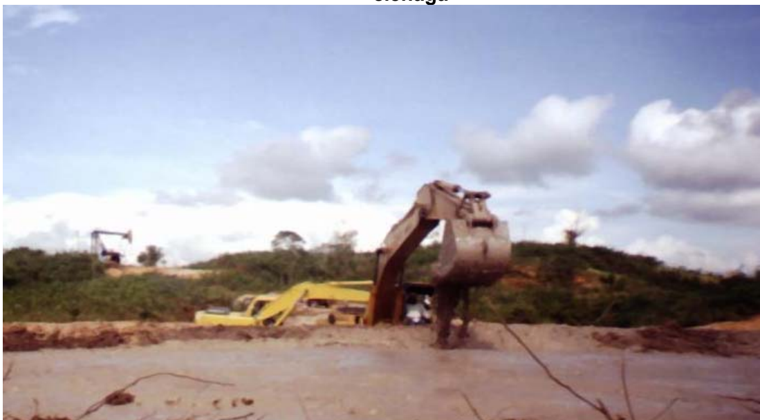
Foto 4. Extracción de lodos y extensión de los mismos en una zona contigua a la ciénaga
