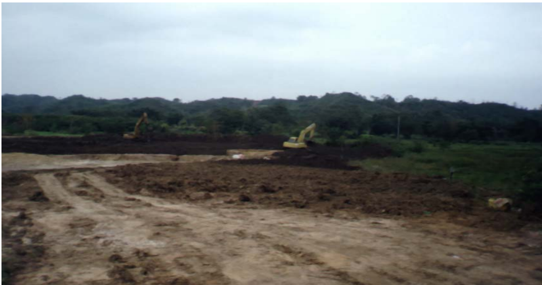
Foto 6. Extensión de lodos contaminados
