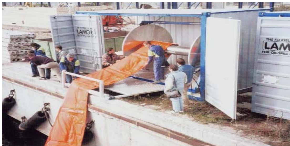
Figura 106. Despliegue de barrera desde embarcación
