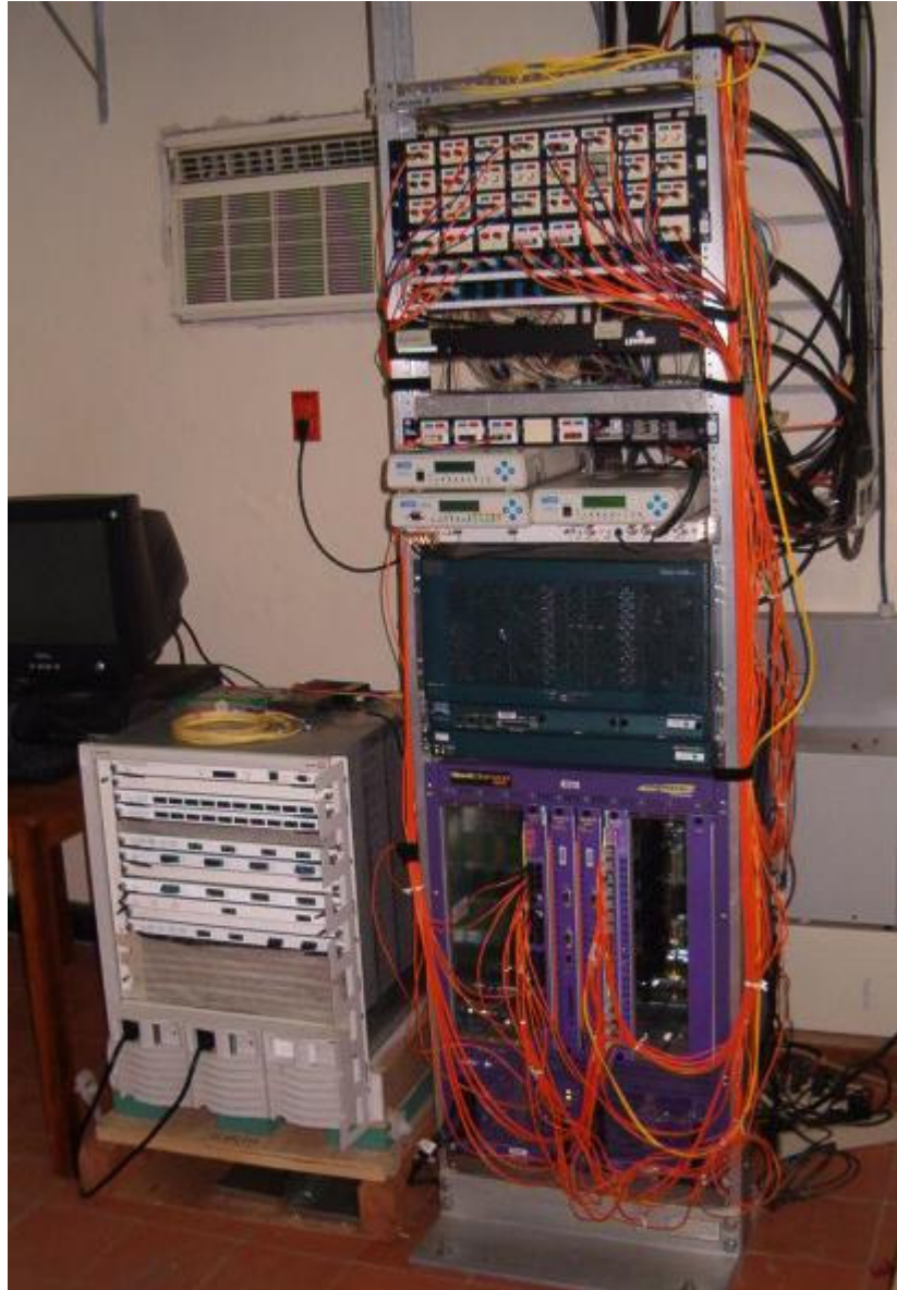
Figura 15 Nodo central de la red UIS, ubicado en la planta telefónica
