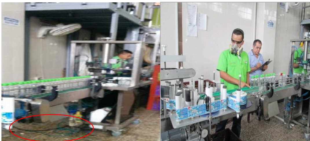
Figura. 37 Organización cableado, antes y después.
