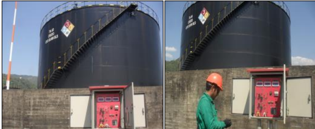
Figura 21: URPC sistemas de protección catódica tanques 01, 02, 03, 04 y TR 05 descargadero Planta Monterrey
