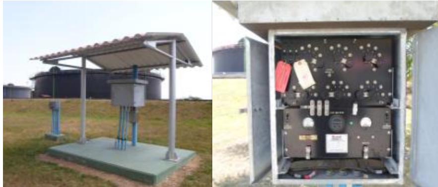
Figura 14: Típico de una unidad rectificadora de protección catódica
