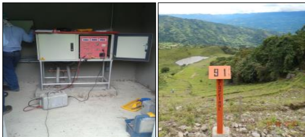
Figura 22 : URPC y estaciones de prueba sistema de protección catódica poliducto
