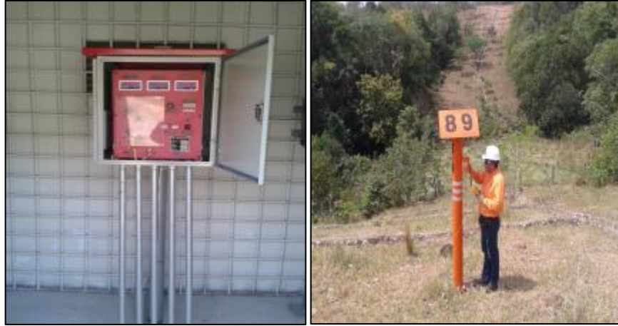
Figura 23: URPC y estaciones de prueba sistema de protección catódica oleoducto API-EPO segmento Monterrey – Altos de Porvenir
