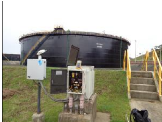
Figura 19: URPC sistema de protección catódica tanques de almacenamiento planta Altos El Porvenir
