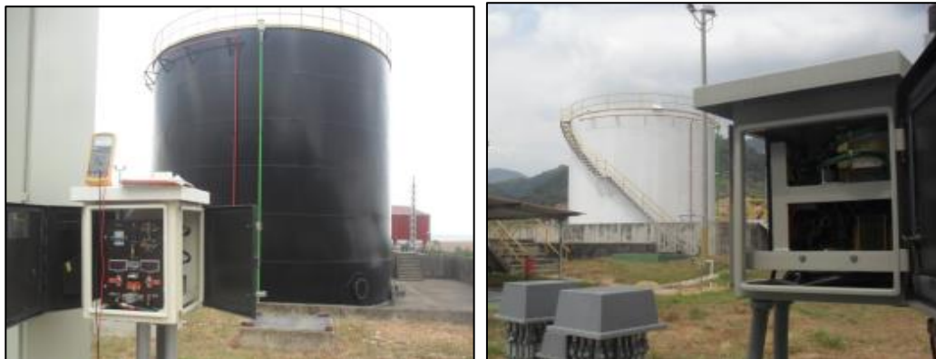
Figura 20: URPC sistemas de protección catódica tanques TQ 85 01 T TK 3501
