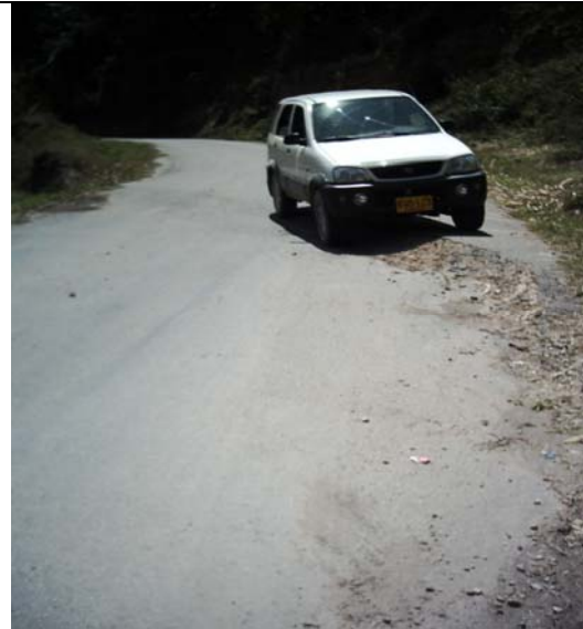
Figura No 48 Desnivel en la calzada.
