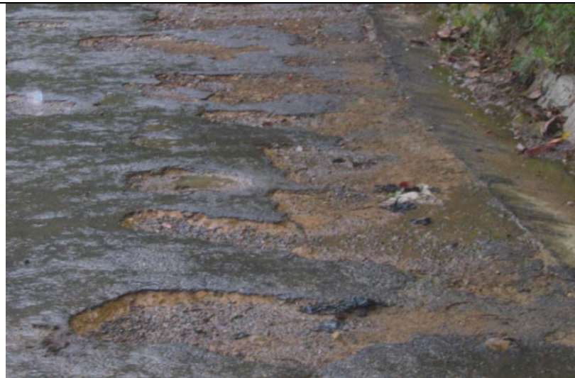
Figura No 54 Desprendimientos continuos en la vía.
