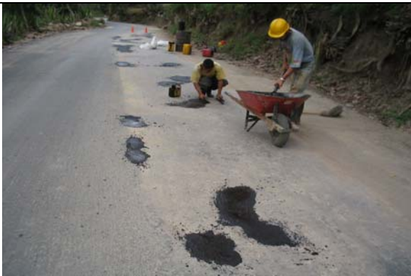
Figura No 28 Reparaciones antes de aplicar el Sello asfáltico en la abscisa K1+900.
