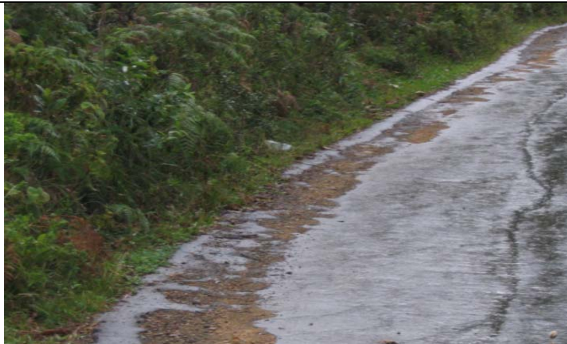
Figura No 55 Surcos o Cárcavas en el hombro de la calzada.
