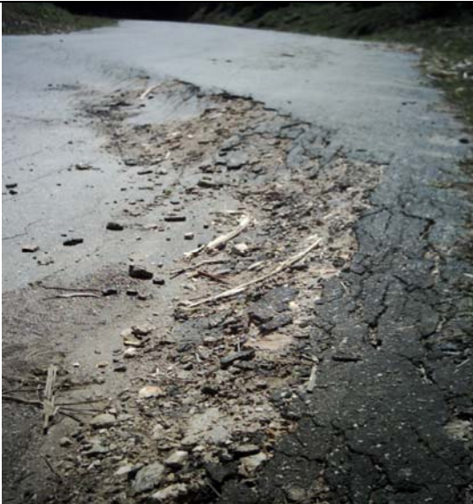
Figura No 47 Inestabilidad de la vía.
