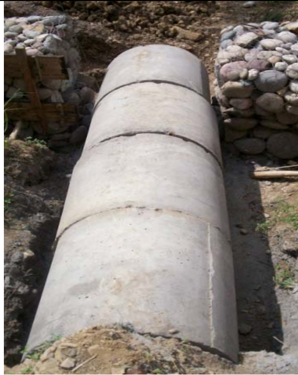
Figura No 4 Tubería de 36" en la salida de la alcantarilla de la abscisa K28+600.
