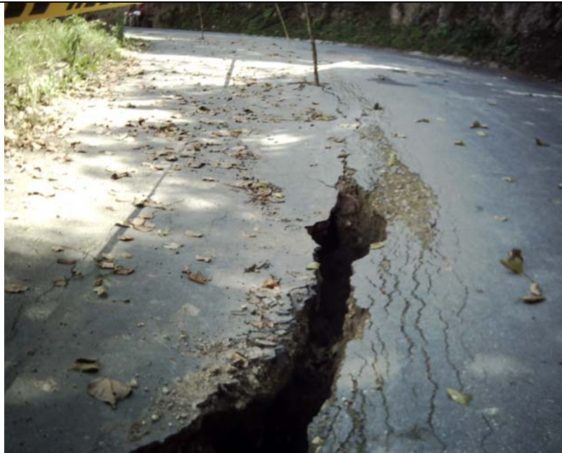
Figura No 43 Agrietamiento originado por la banca.
