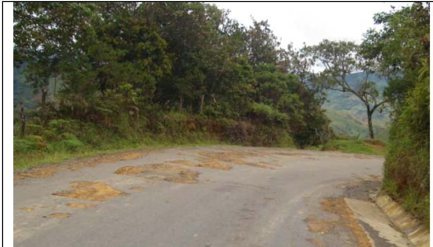
Figura No 53 Varios desprendimientos del Slurry Seal.
