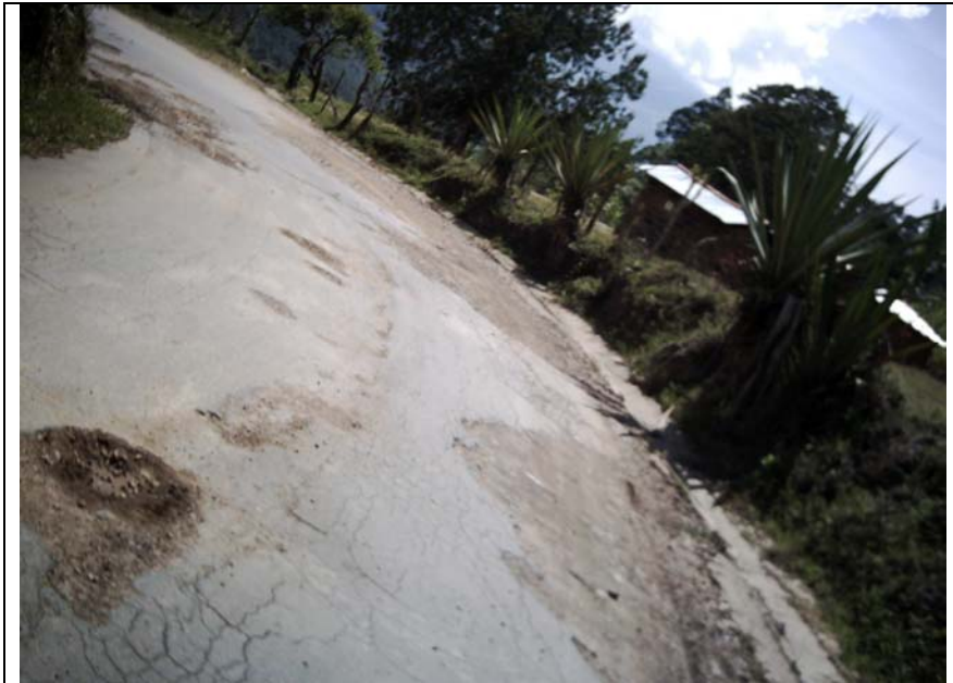
Figura No 46 Pérdida parcial del agregado de la base estabilizada.
