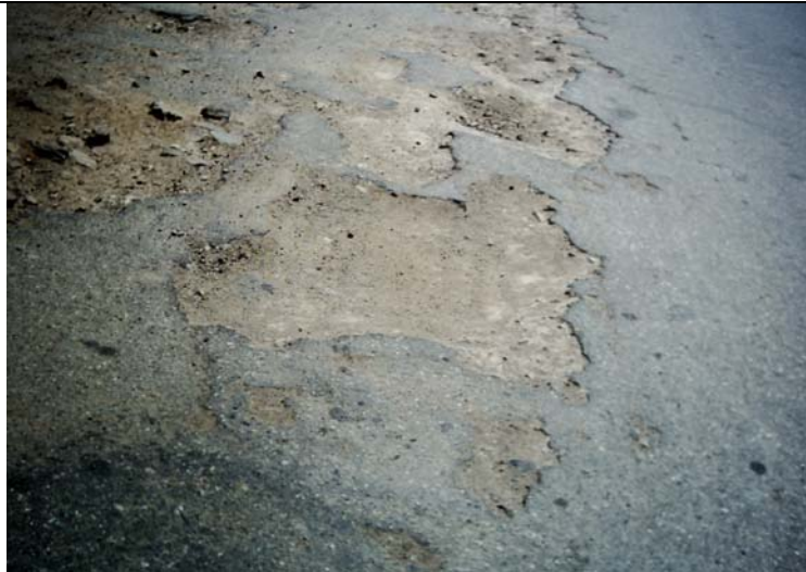
Figura No 44 Desprendimientos de la emulsión asfáltica.
