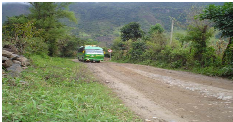
Figura No 14 Estado inicial de la vía.
