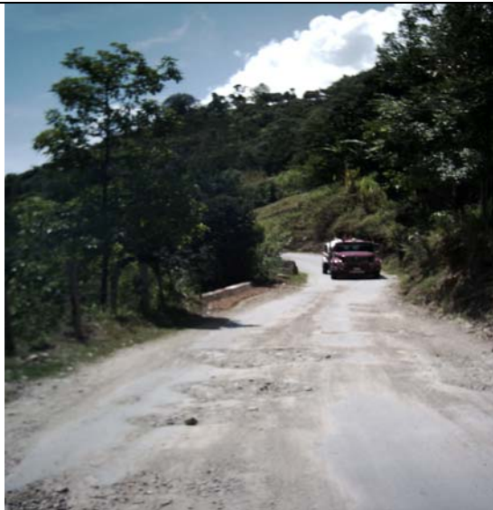
Figura No 45 Continuos desprendimientos del tratamiento.
