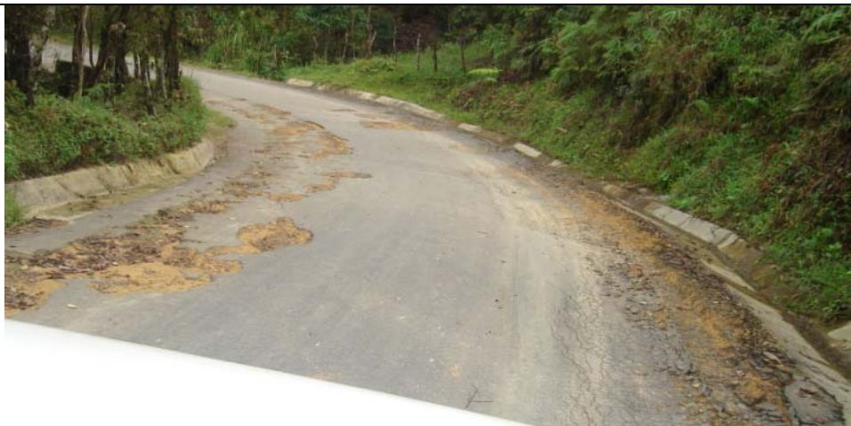
Figura No 56 Mayores daños debido a la humedad.
