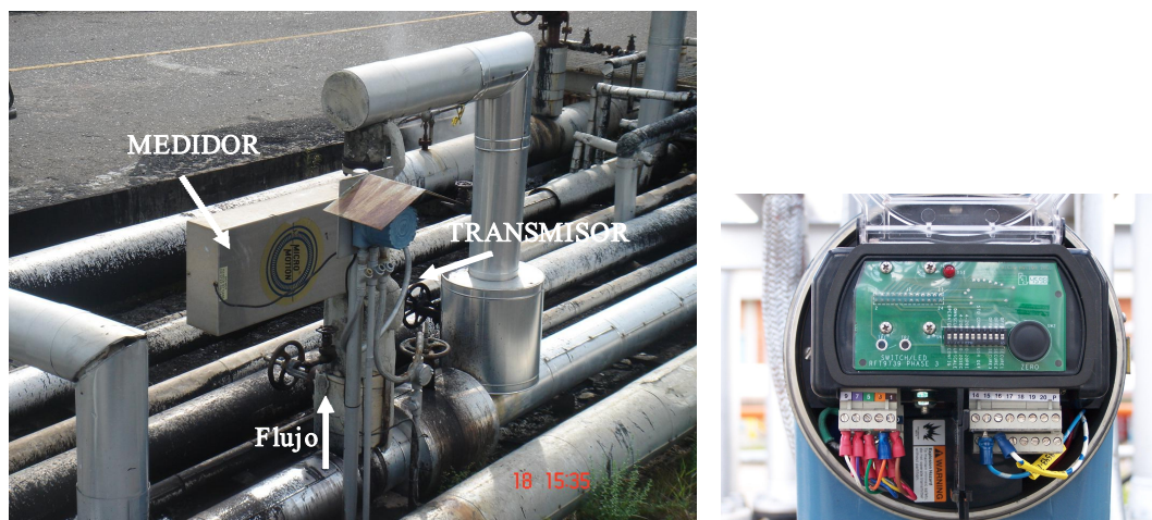
Figura 14. Medidor Coriolis y transmisor instalados en la planta de Balance
