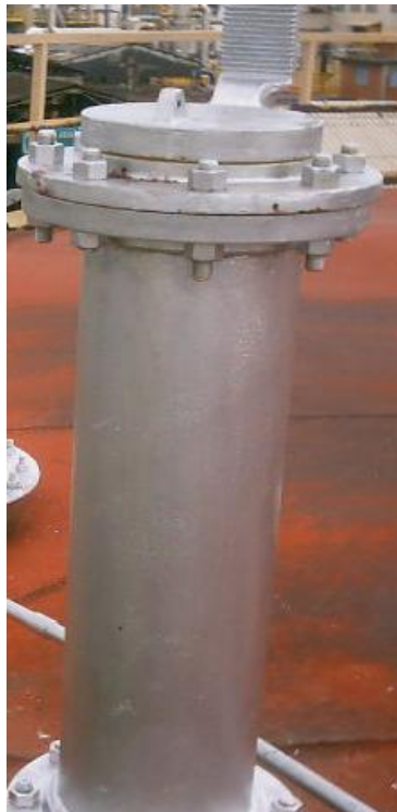
Figura 21. Escotilla de medición de tanques
