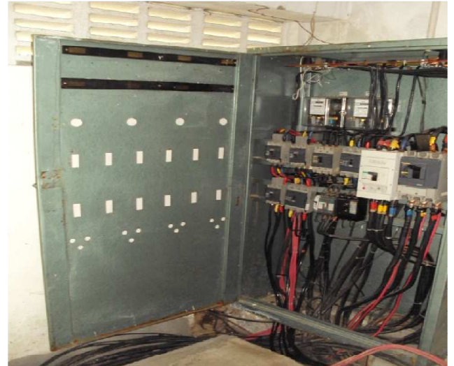
Figura 13. Vista Tablero General de Baja Tensión Fuente:
