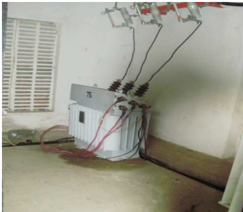
Figura 19. Vista Transformador 75 kVA
