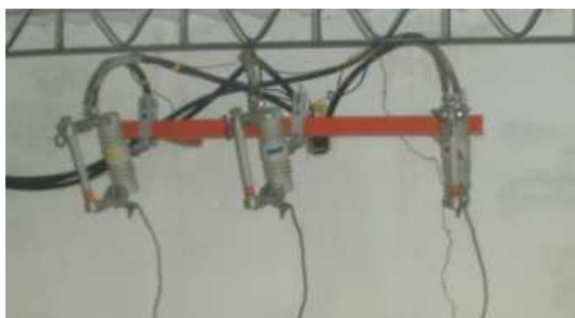
Figura 26. Vista Cajas Cortacircuitos Transformador 200 kVA
