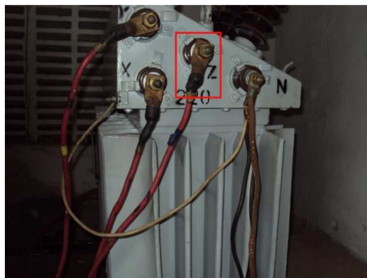
Figura 21. Vista Borne con anomalías del Transformador 75 kVA
