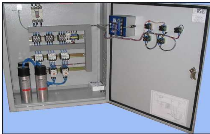
Figura 53. Celda Banco de condensadores con módulo de control del factor de potencia
