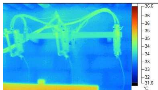
Figura 27. Termografía Cajas Cortacircuitos Transformador 200 kVA
