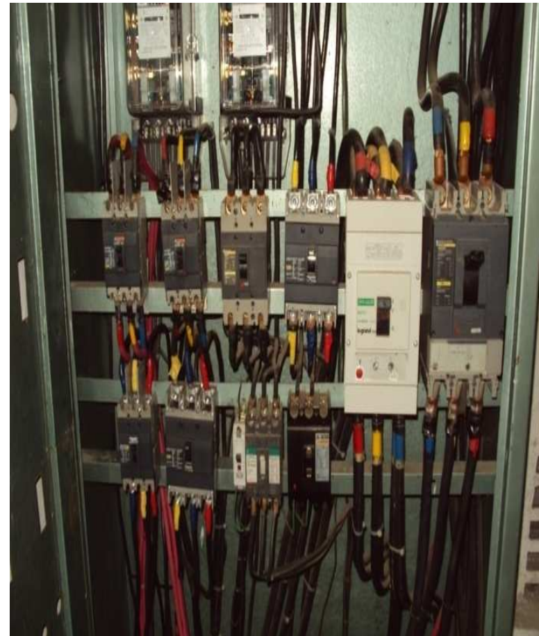
Figura 11. Tablero General Existente
