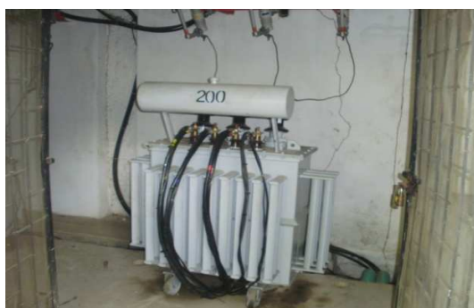
Figura 24. Vista Transformador 200 kVA
