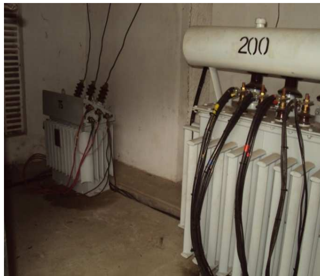
Figura 8. Vista General de los Transformadores
