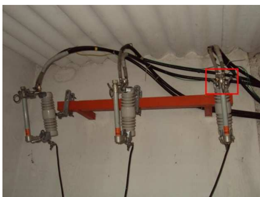
Figura 22. Vista del anillo de maniobra con anomalía del Transformador 75 kVA
