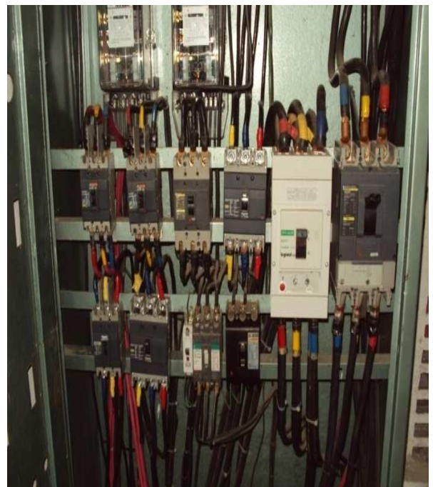
Figura 14. Vista Totalizadores Tablero General
