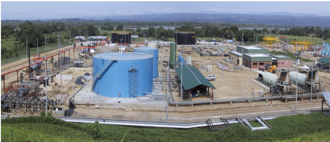
Figura 9. Módulo de tratamiento y bombeo
