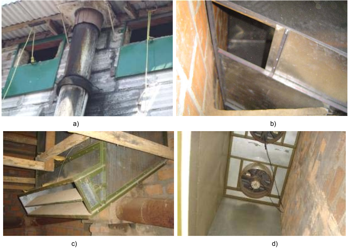
Figura 97 Elementos del recirculador RAF: a) compuertas de entrada de aire fresco; b) cavidades de salida de aire recirculado hacia los tubos; c) flap de regulación de aire recirculado; d) ventiladores axiales SIEMENS monofásicos.
