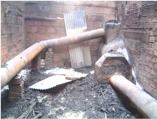
Figura 18 Detalle de un horno incendiado
