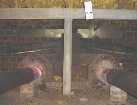
Figura 17 Tubería al rojo en etapa de secado de lámina
