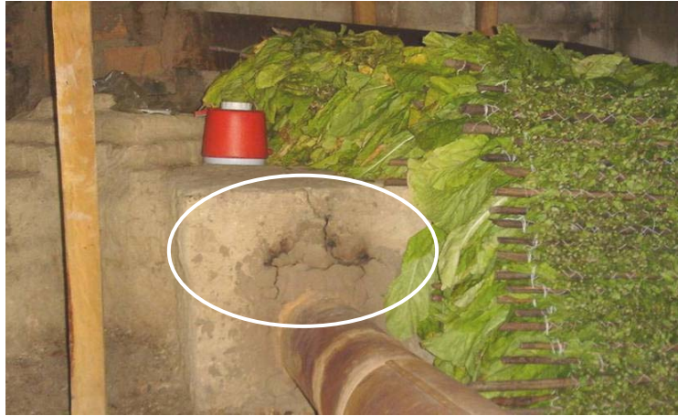
Figura 12 Grietas generadas por la dilatación térmica en la hornilla
