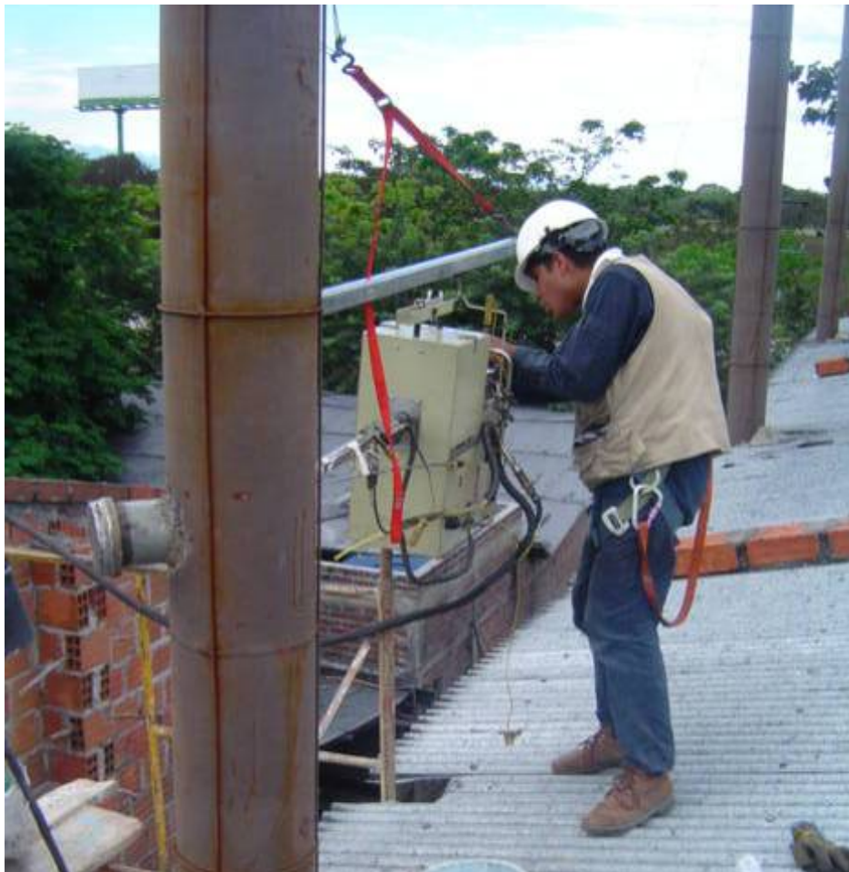
Figura 86 Analizador ORSAT colocado en el conducto chimenea
