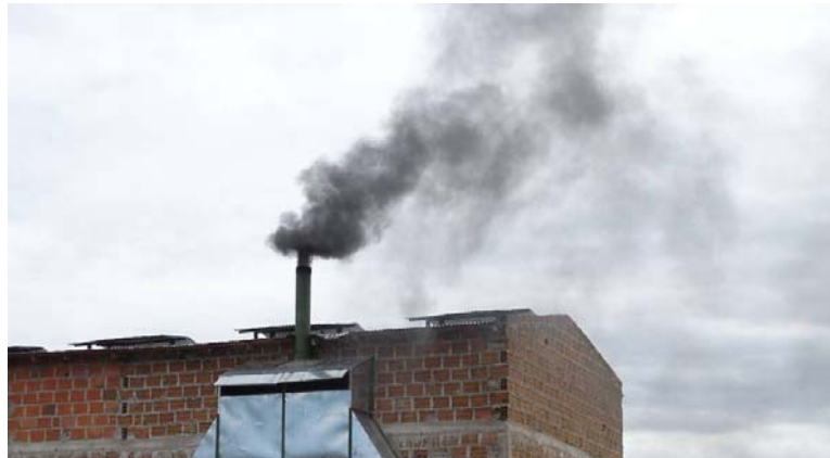
Figura 40 Formación de humos negros en la chimenea
