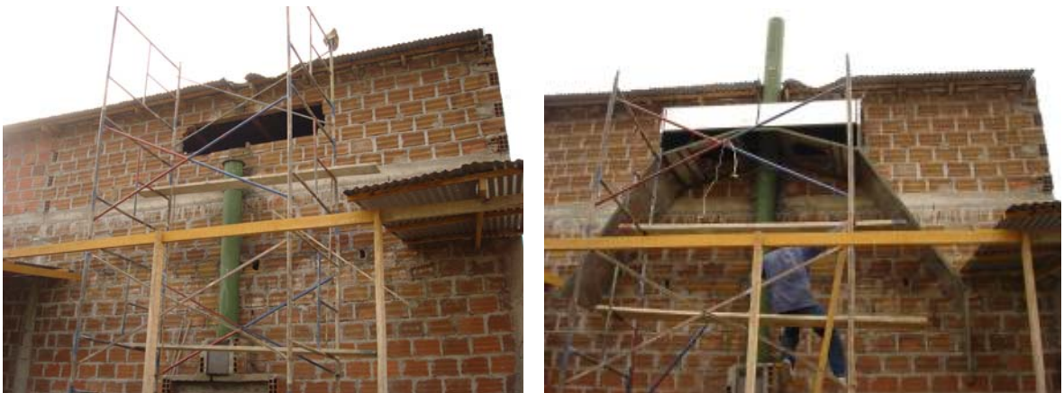
Figura 132 Montaje del recirculador en horno situado en la zona rural de Yaguará (Huila)
