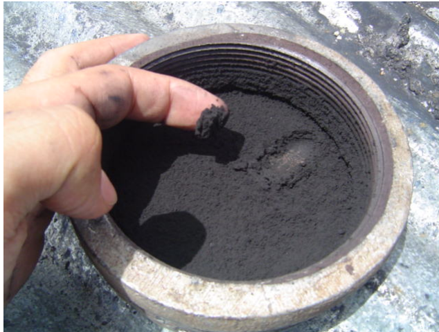
Figura 54 Película de hollín en tramo de chimenea
