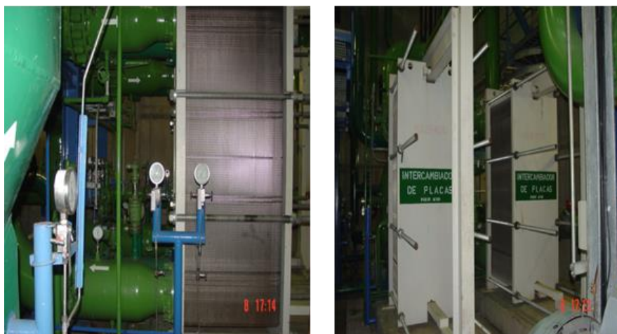
Figura A. 1. Intercambiadores de calor de C.E.S
