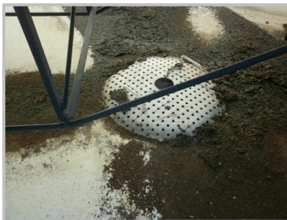
Fotografía 25: Estado del drenaje.
