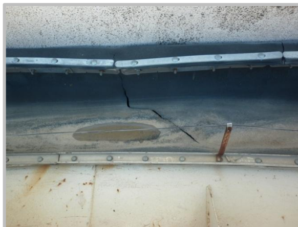
Fotografía 24: Sello secundario agrietado.
