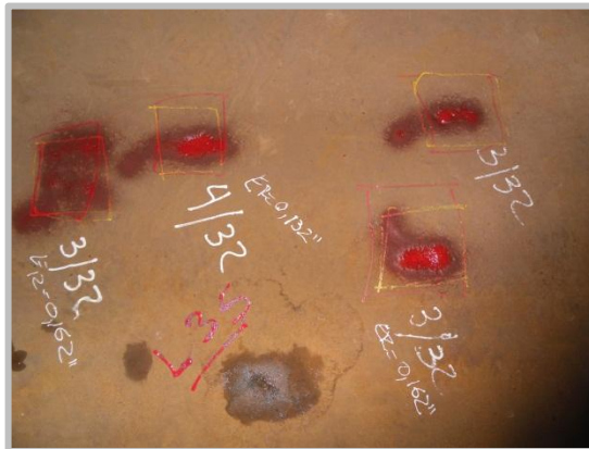
Fotografía 28: Picaduras en fondo.
