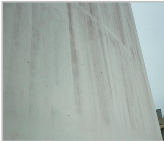
Fotografía 10: Recubrimiento en mal estado.
