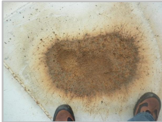
Fotografía 20: Picaduras no críticas.
