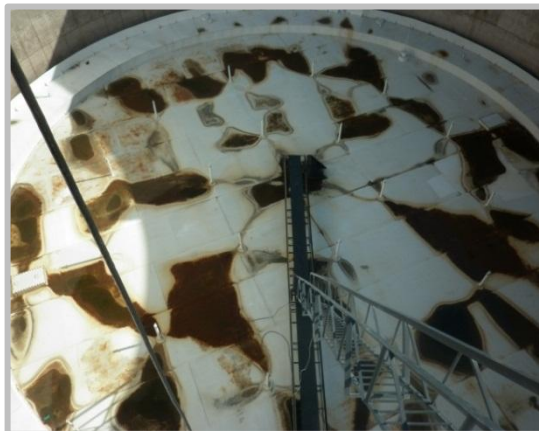
Fotografía 21: Estancamientos de Agua.
