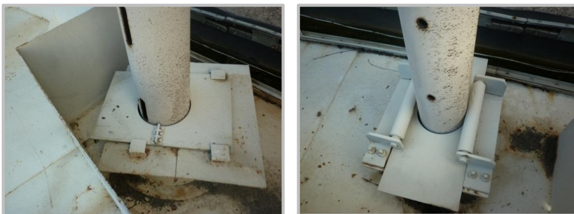
Fotografías 26 y 27: Tuberías sistema de medición y de muestreo respectivamente.
