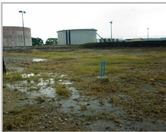
Fotografía 6. Patio y dique con vegetación.
