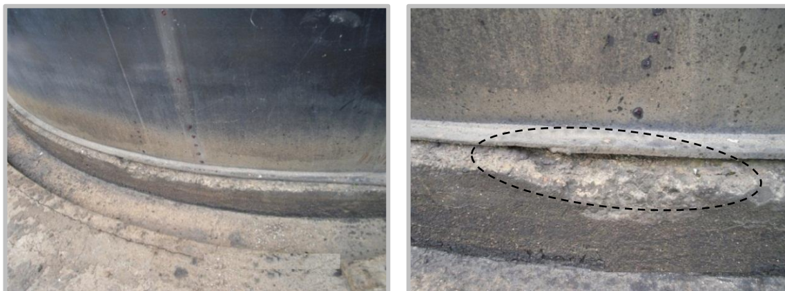
Fotografías 2 y 3. Despotrillamientos encontrados en la fundación.
