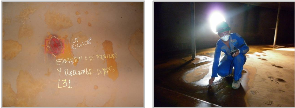
Fotografías 32 y 33: Bajo espesor en L31, verificación por UT.
