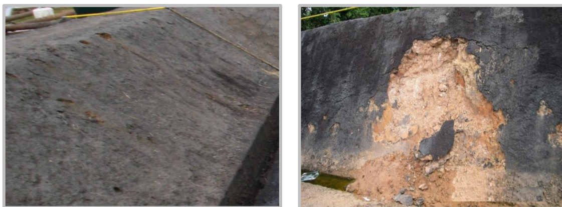
Fotografías 4 y 5. Pérdidas localizadas y erosión en dique de contención.
