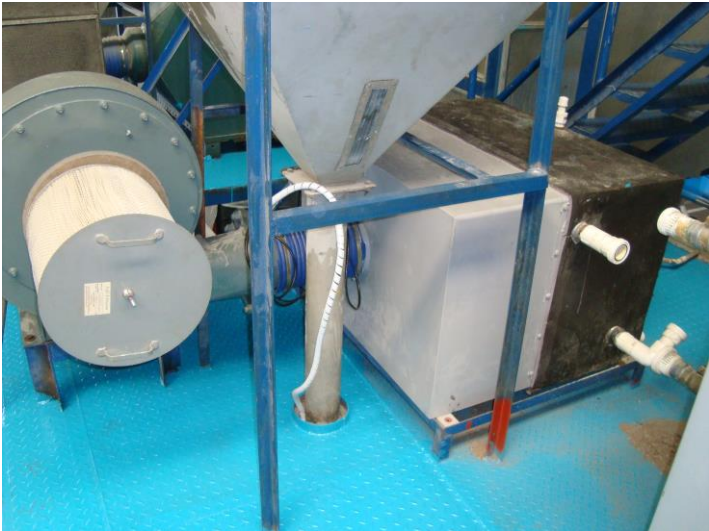
Figura 34. Sistema de refrigeración y control de flujo del anillo de aire
