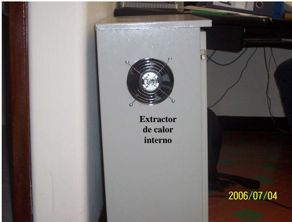
Figura 56 Vista lateral izquierda del generador
