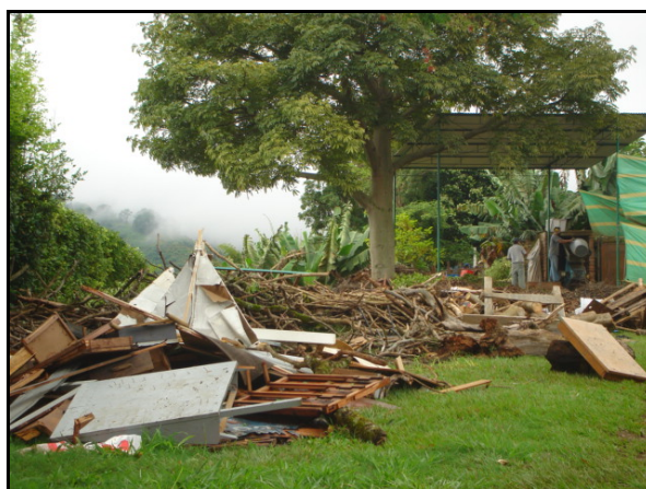
Figura 24. Centro de acopio de los residuos de desbaste
