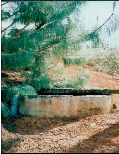
Fotografía 6. Caja de inspección y almacenamiento de lixiviados
