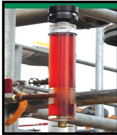
Figura 194. Botella de inspección.
