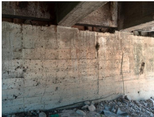
Figura 4, Estado actual de estribos y apoyos; Elaboración autores, 17 de Julio de 2014.
