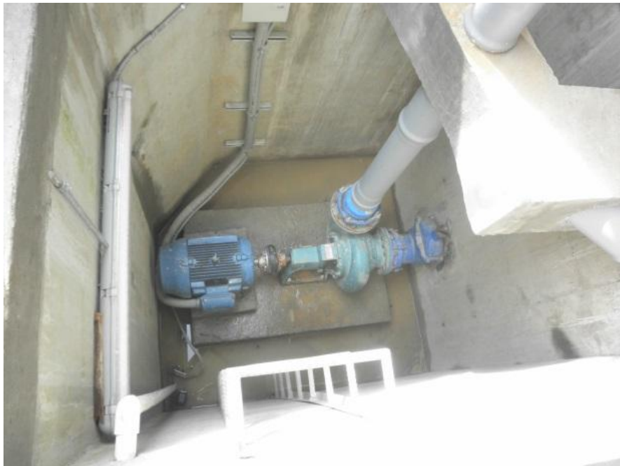
Figura 12. Fotografía, cámara de bombeo
