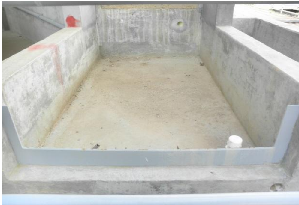
Figura 19. Fotografía vertedero de pared delgada, ubicado a la salida del cuenco amortiguador
