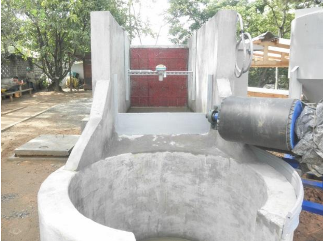
Figura 17. Fotografía, del tanque Mezclador
