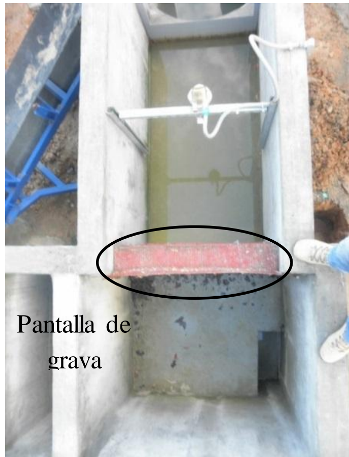
Figura 14. Fotografía, tanque de aquietamiento
