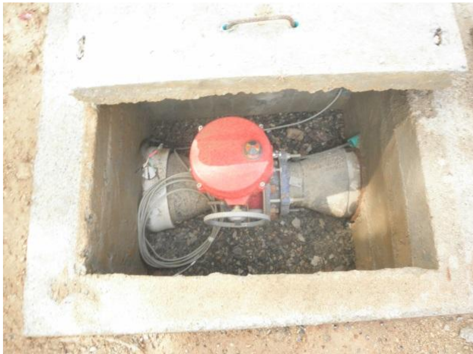
Figura 13. Fotografía, Servo válvula eléctrica
