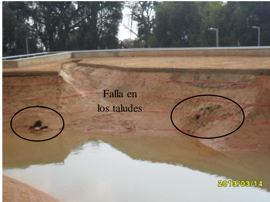
Figura 7. Fotografía, Taludes fallados por la infiltración
