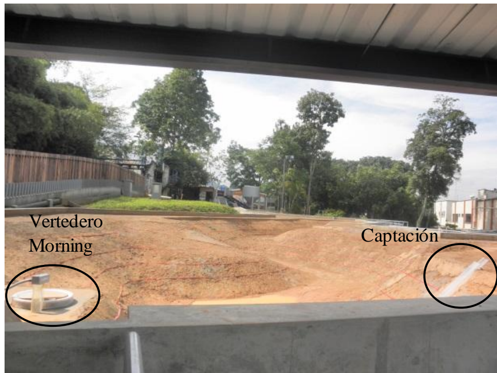
Figura 6. Fotografía, Tanque del embalse construido inicialmente con capa superficial en arcilla
