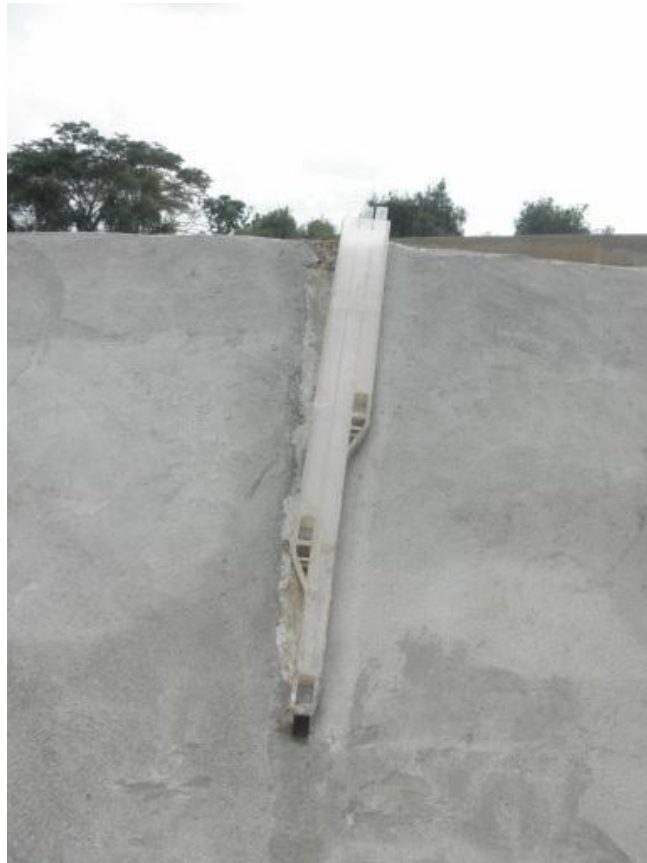
Figura 10. Fotografía, sistema de captación
