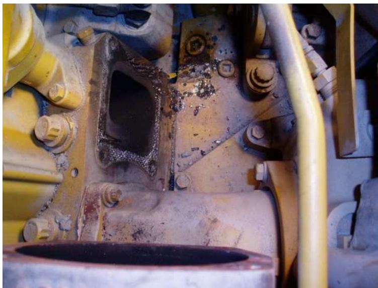
Figura 21. Foto de una fuga de gases de escape presente en un motor de D11R
