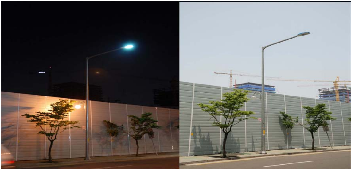
Figura 28. Usos de luminarias con leds en alumbrado público
