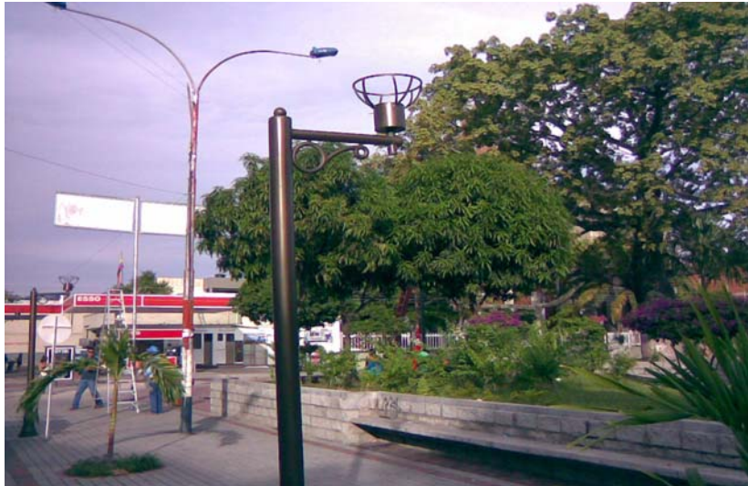
Figura 9. Vandalismo sobre una luminaria ornamental de un parque
