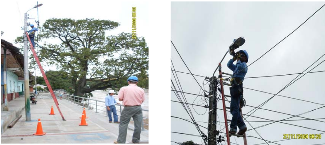
Figura 38. Riesgos en alumbrado público (caídas de altura y riesgo eléctrico)
