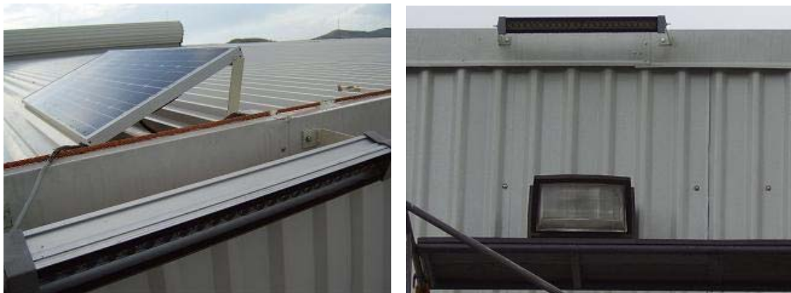
Figura 29. Utilización de paneles solares en iluminación industrial
