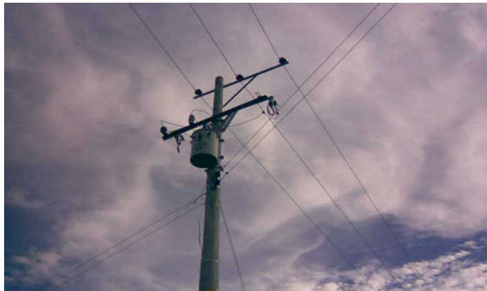
Figura 14. Transformador de distribución exclusivo de alumbrado público
