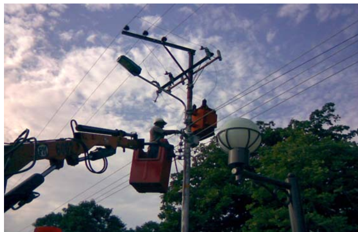
Figura 13. Mantenimiento preventivo de luminarias y reflectores
