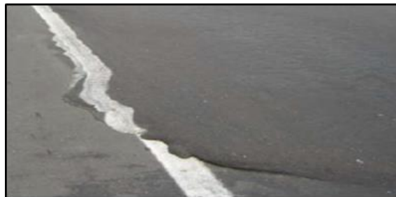
Figura 4. Abultamiento en el pavimento
