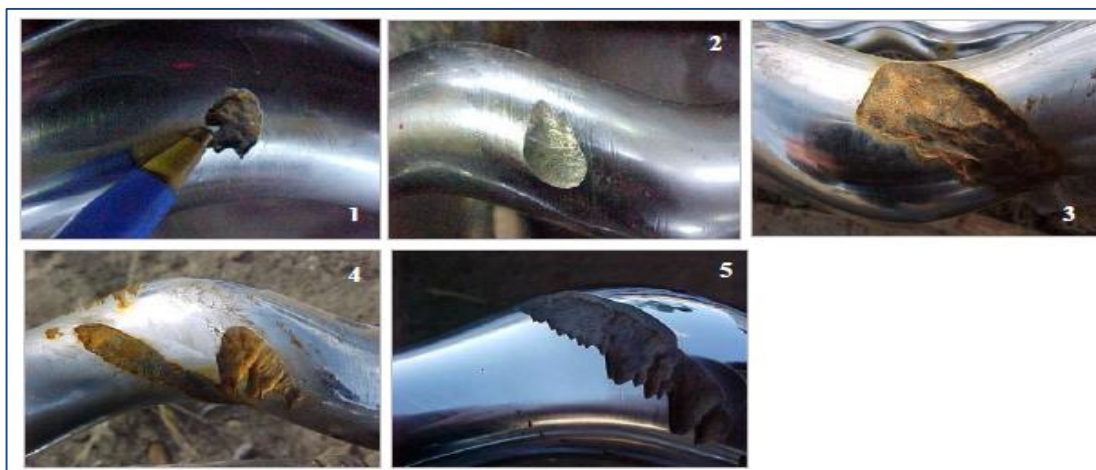
Figura 20. Desgaste Profundo Localizado.
