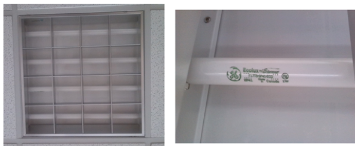
Figura 4.1: Luminarias salas de cómputo, recepción y oficinas
