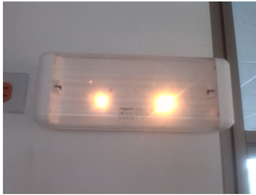
Figura 4.5: Luminarias de emergencia
