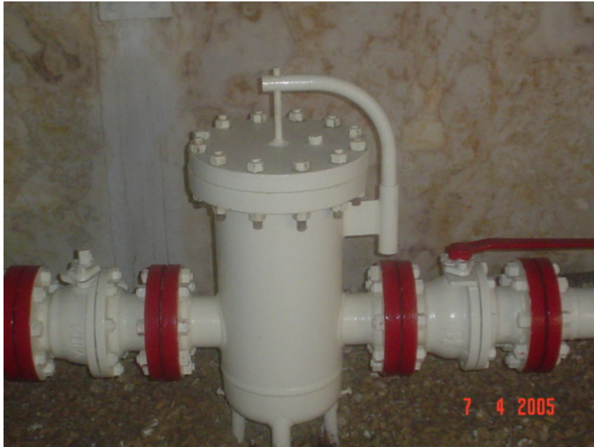
Foto 5. Filtro CFR Estación Río Frío
