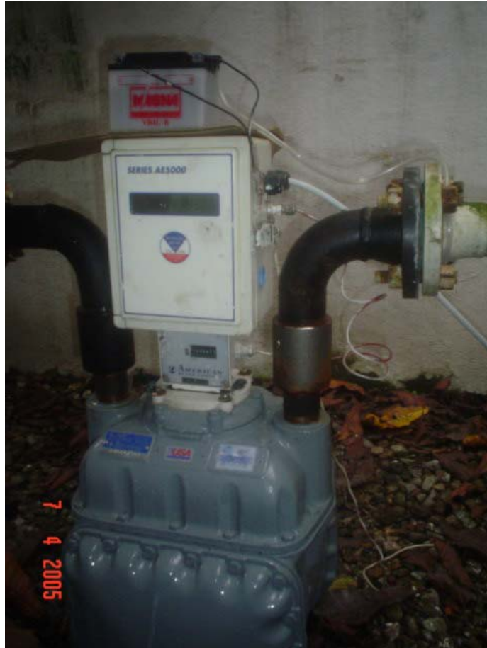
Foto 7. Medidor 3GT y Electrocorrector American Meter Estación Reguladora y Medidora de Ruitoque
