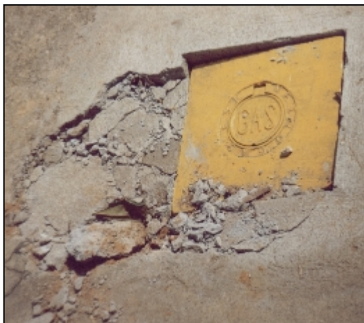
Foto 18. Tapa de poliválvula en mal estado
