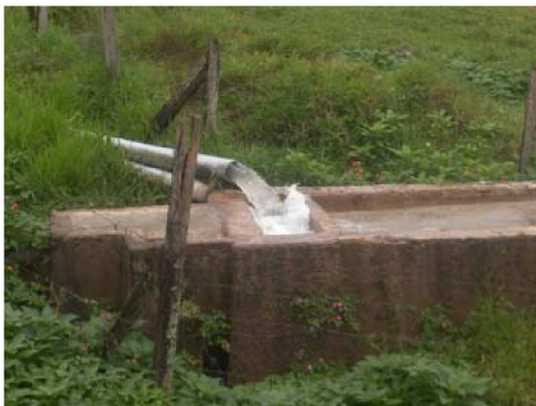
Foto No. 25 Línea de aducción Caney 1
