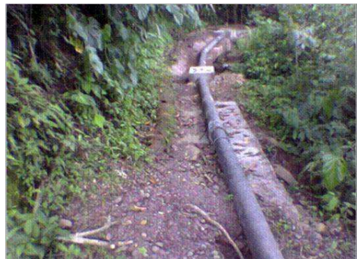
Foto No. 26 Línea de aducción Caney 2
