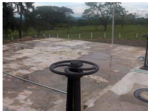
Foto No. 33 Tanque de Almacenamiento Caney 2
