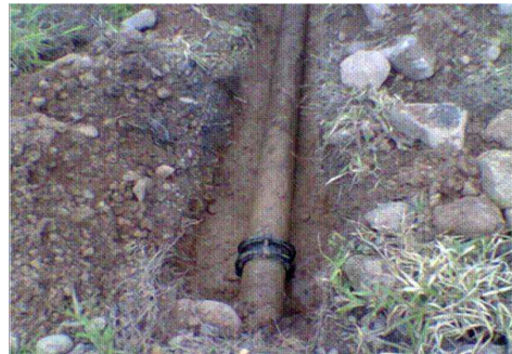
Foto No. 30 Línea de conducción Caney 2
