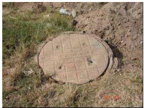
Foto No. 21 Pozo de Inspección en mal estado
