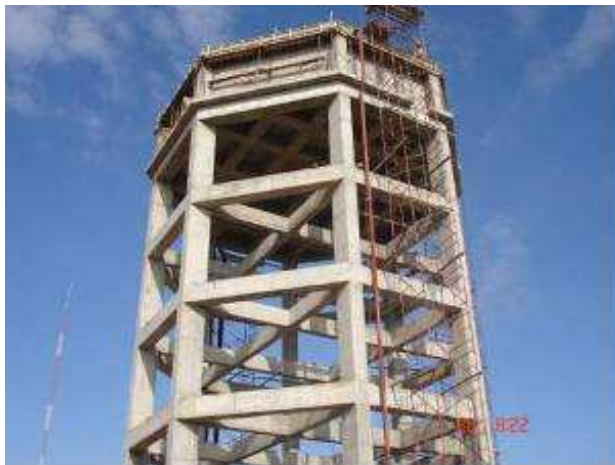
Foto No. 19 Tanque de almacenamiento
