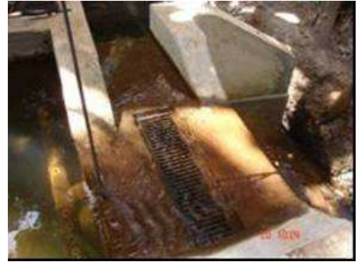
Foto No. 15 Captación La Carolina
