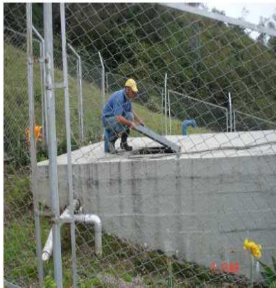
Foto No. 9 Tanque de Almacenamiento
