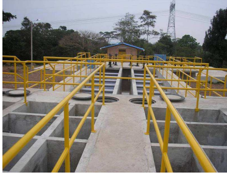
Foto No. 31 PTAP
