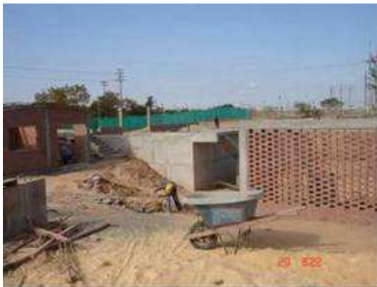
Foto No. 17 Instalaciones de la PTAP
