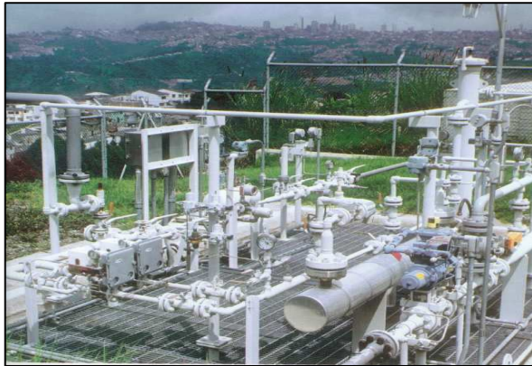
1. City Gate Estación entrega transportador
