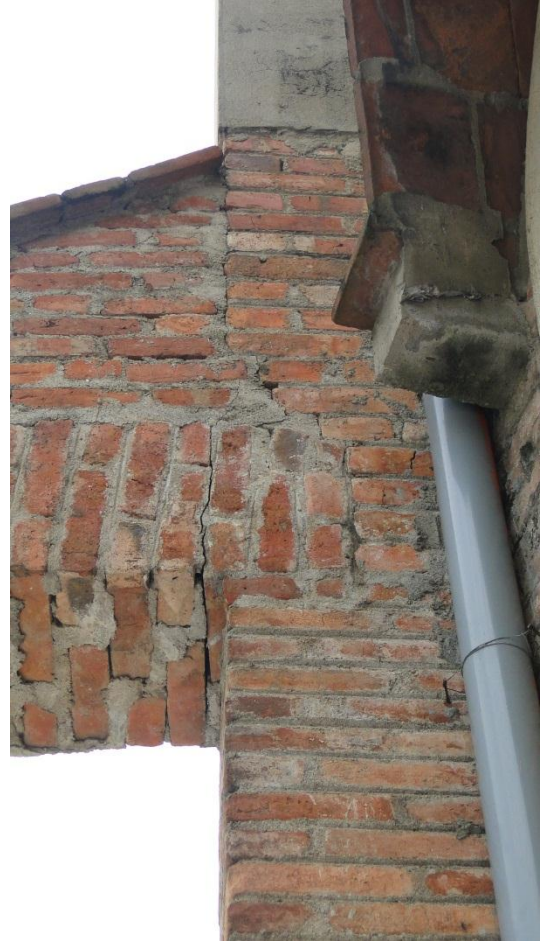
Figura 6: Arbotante con deficiente traba en sus ladrillos y consecuente falla por agrietamiento.
