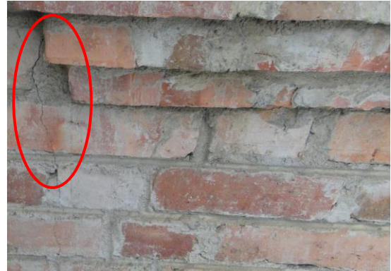
Figura 30: Falla por cortante en una ventana del ábside
