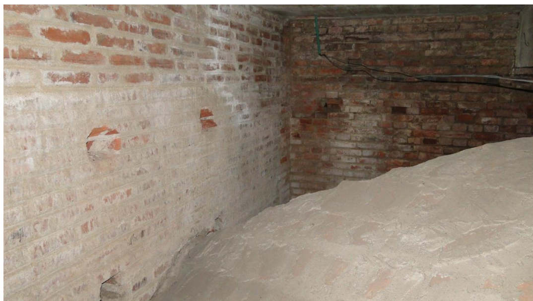
Figura 7: Problemas de humedad y filtraciones en la cara interna de los muros de la fachada frontal
