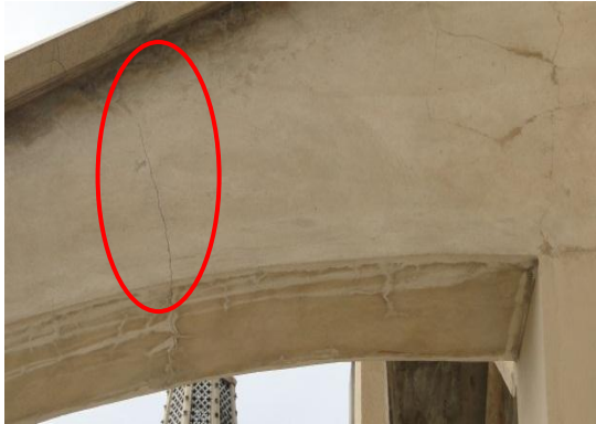
Figura 29: Falla por cortante en un arbotante
