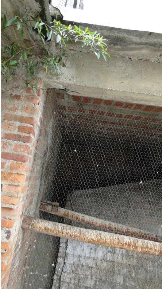
Figura 5: Presencia de vegetación y pérdida de material en la mampostería.
