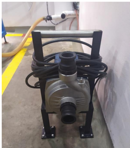
Figura 16. Moto bomba instalada por parte de TodoAseo S.A.S.
