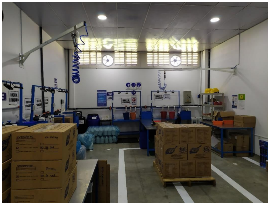
Figura 14. Brazos giratorios instalados en la planta de producción.
