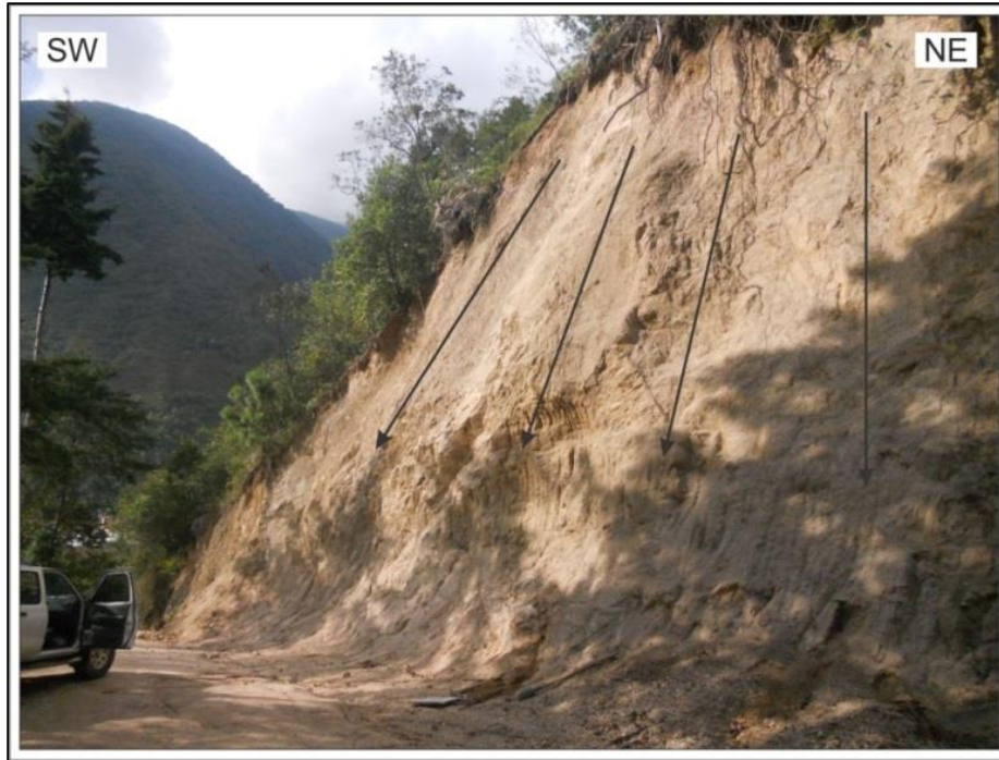
Figura 74. Caída de detritos sobre la vía que conduce hacia la vereda La Salina.
