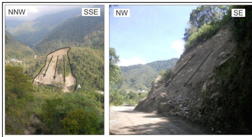
Figura 72. Deslizamiento traslacional de grandes dimensiones en la vía Bucaramanga.
