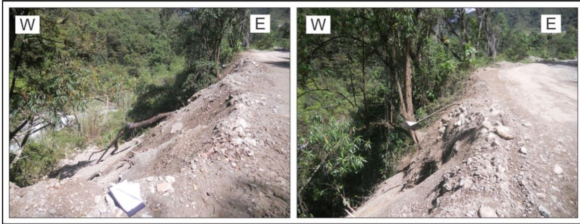
Figura 73. Prolongación del deslizamiento hacia el margen Este del Río Umpalá.
