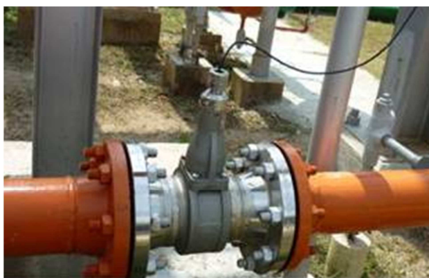
Figura 7. Medidor tipo “vortex” sobre la salida del scrubber
