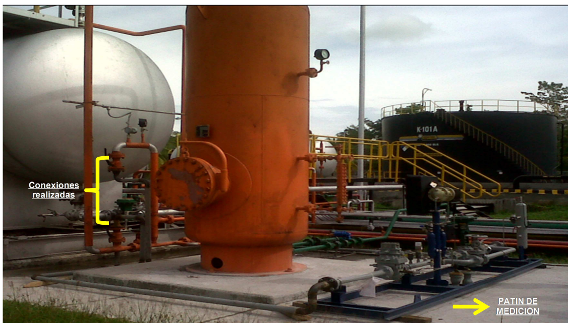
Figura 8. Montaje de medidor temporal en ERT&C-2/3
