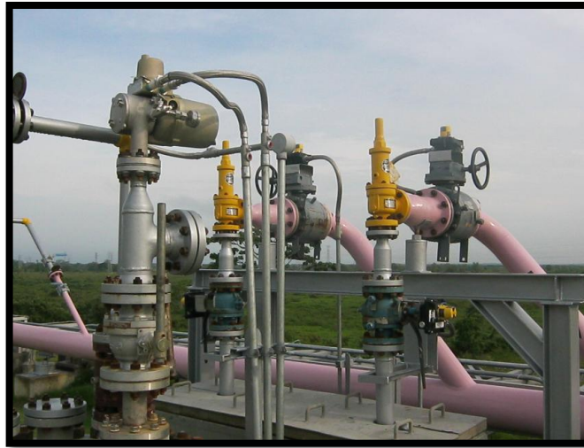
Figura 22. Válvulas de alivio de presión de la Nueva Estación de GLP
