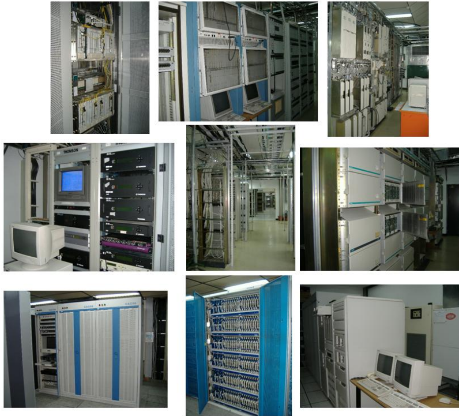
Figura 13. Equipos de la Zona Larga Distancia
