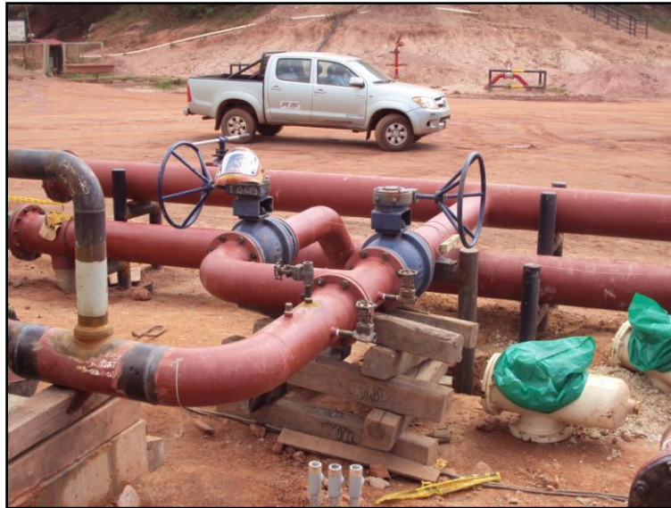
Fotografía 3. Sistema de succión de las bombas.
