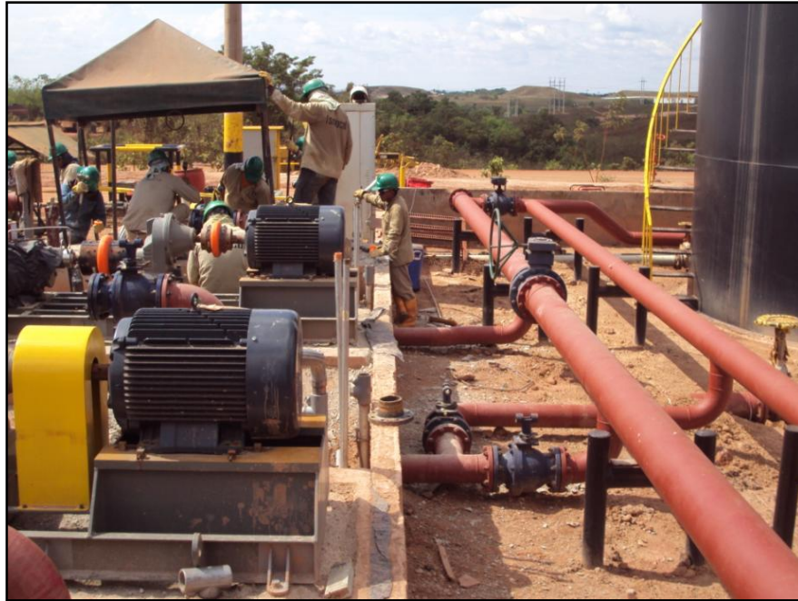
Fotografía 5. Sistema de descarga de las bombas.
