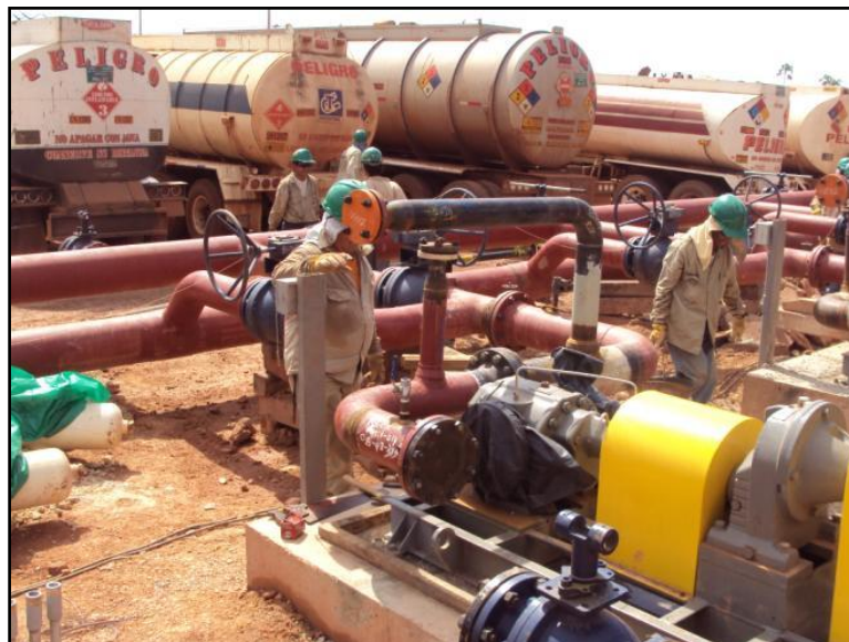
Fotografía 4. Sistema de alivio de las bombas.
