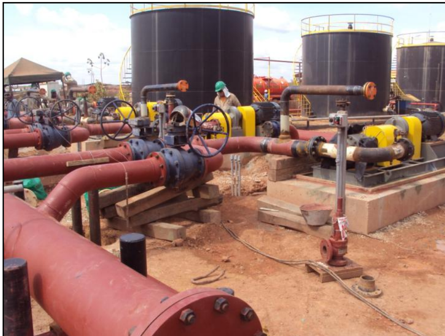
Fotografía 6. Sistema de encendido y apagado de las bombas.
