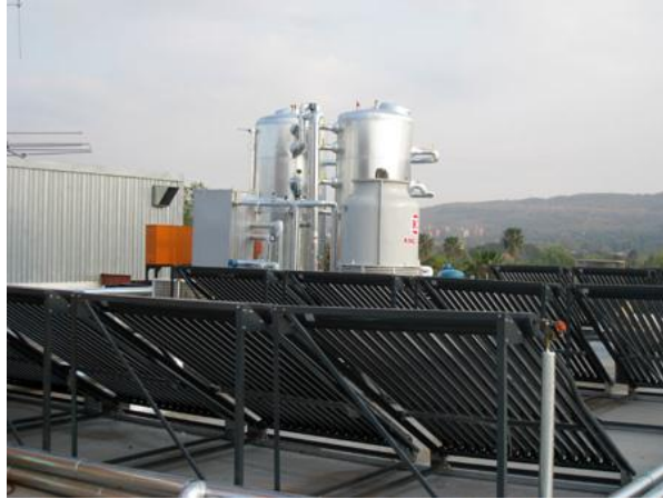
Figura 177. Sistema de refrigeración solar para el hospital MOOT en Sudáfrica
