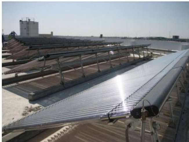
Figura 178. Instalación de refrigeración solar en las oficinas de ESAB en Dubai
