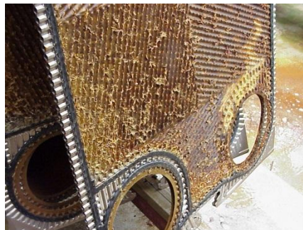
Figura 52. Depósito de sedimentos en Intercambiadores de calor
