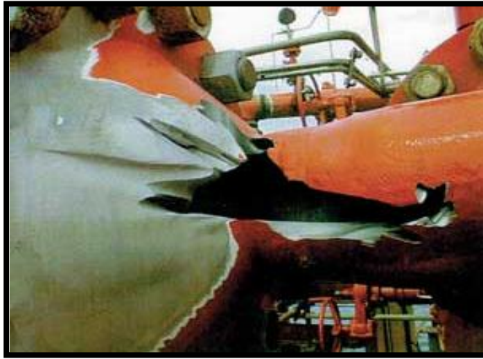
Figura 12. Abrasión de equipos en superficie.
