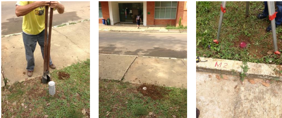
Figura 19. a) Excavación para materialización del mojón con la coordenada de amarre, b) localización del mojón respecto al edificio a levantar. c) mojón M2 marcado.
