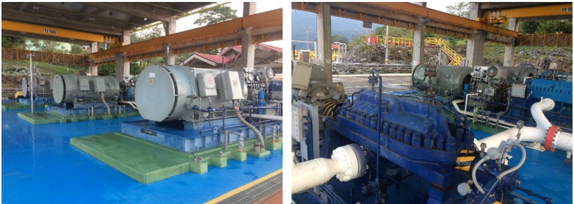
Figura 5. Disposición motores y bombas Planta Santa Rosa
