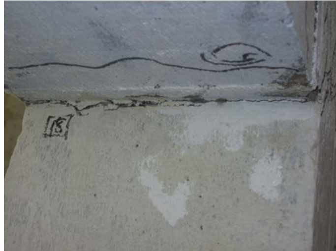
Imagen 19. Fisuras del 2 ciclo, parte inferior de la viga.
