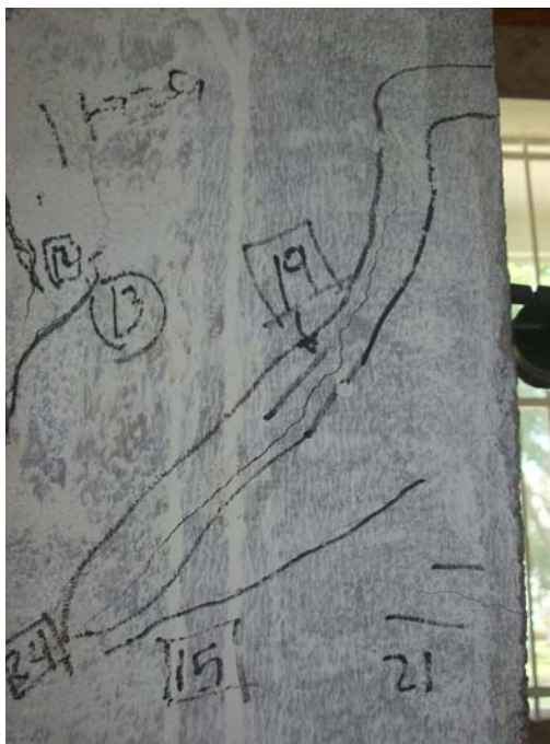
Imagen 20. Fisuras del 3 ciclo, nodo.
