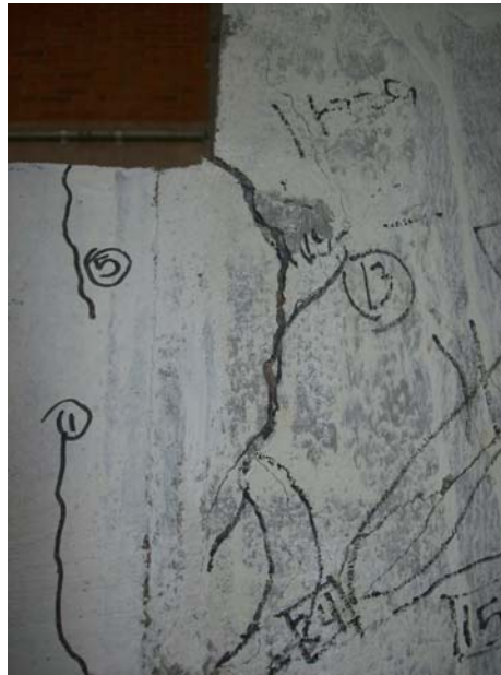
Imagen 27. Fisuras del 6º ciclo, nodo.
