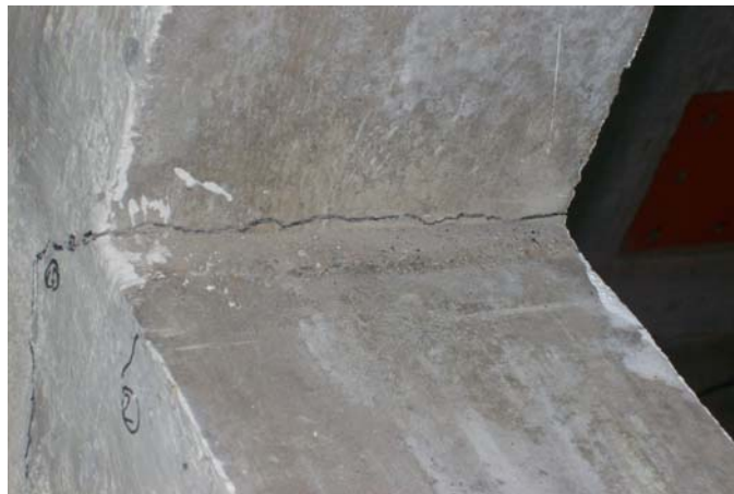
Imagen 18. Fisuras del 2º ciclo, parte superior de la viga.
