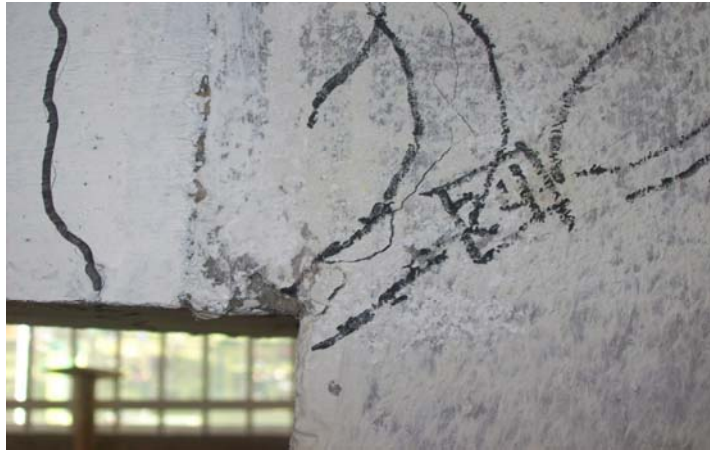
Imagen 21. Fisuras del 3º ciclo, nodo.
