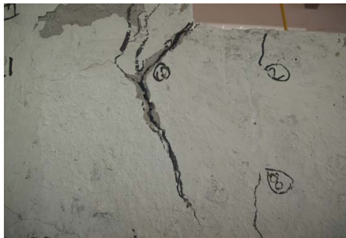
Imagen 26. Fisuras del 6º ciclo, nodo.
