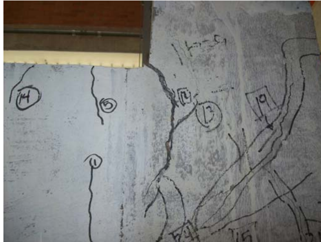
Imagen 25. Fisuras del 5º ciclo, nodo.
