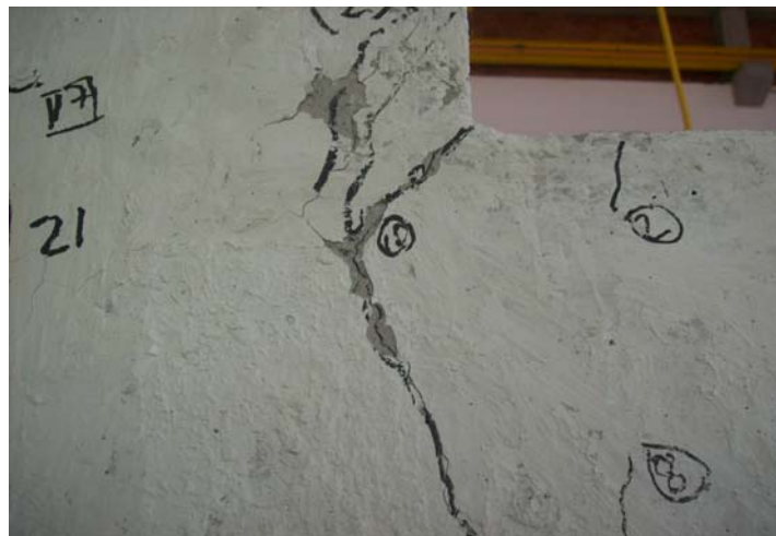
Imagen 22. Fisuras del 4º ciclo, nodo.
