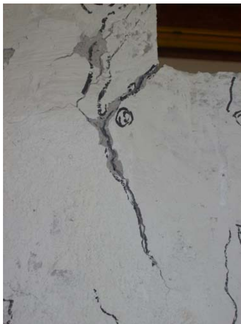
Imagen 24. Fisuras del 5 o ciclo, nodo.
