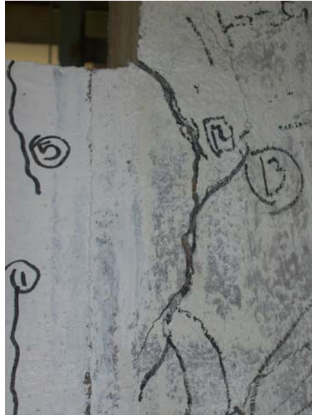
Imagen 23. Fisuras del 4º ciclo, nodo.
