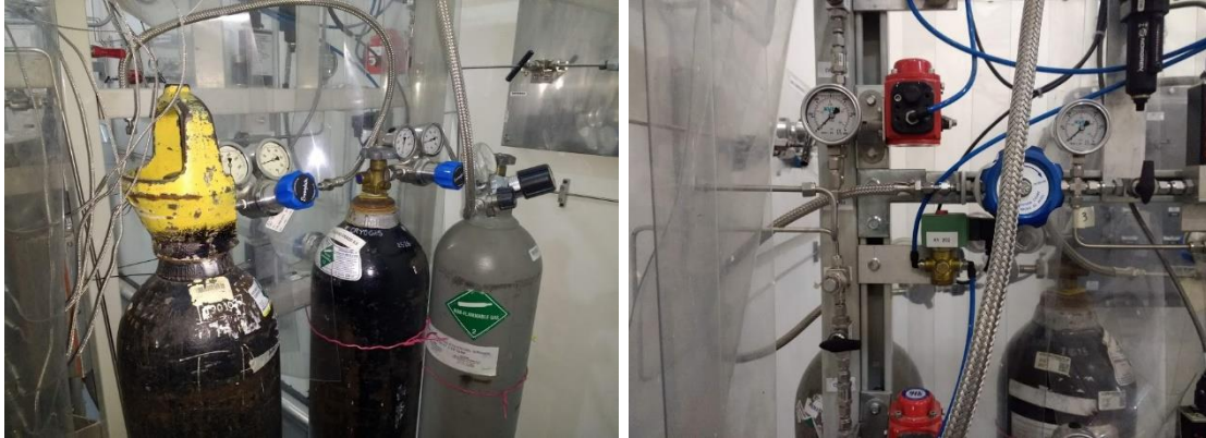
Figura 41. Cilindros de nitrógeno utilizados para la coinyección de gases en el arreglo experimental del equipo RTO.
