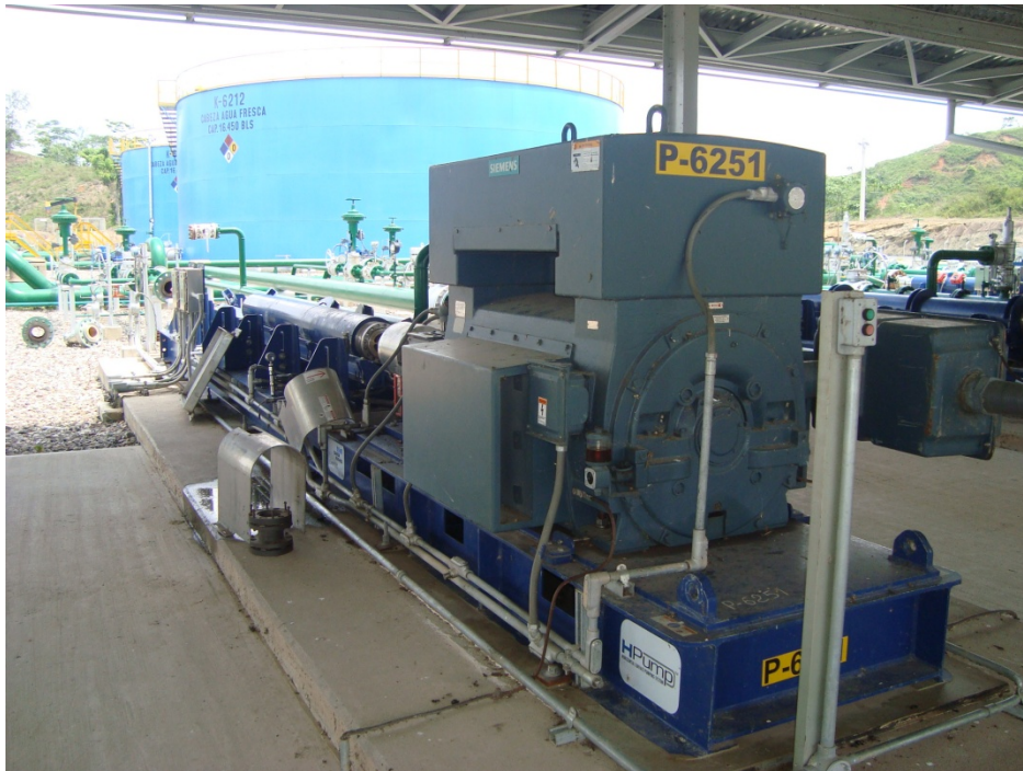
Figura 25. Conjunto motor bomba instalado en la PIA5A
