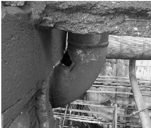
Figura 35. Fallo de sulfidación del codo de la tubería.
