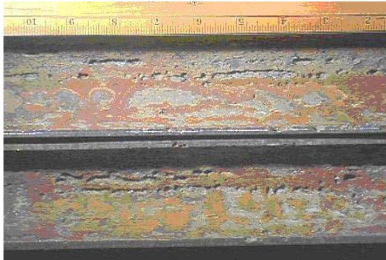
Figura 31: Corrosión con CO 2 de una línea de flujo de producción de petróleo y gas de acero al carbono. Análisis, "McGraw-Hill, Inc., NY, 1991, pp. 259-263.
