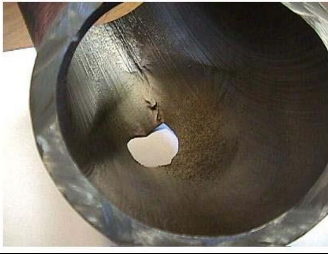
Figura 27. Erosión de una curva de retorno del calentador coker 9cr.
