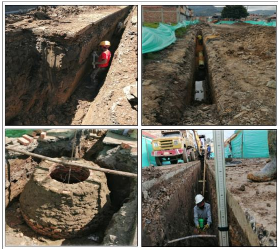
Figura 15. Registro fotográfico, construcción y/o mejoramiento de la red de alcantarillado sanitario y pluvial en el municipio de Simijaca – Cundinamarca.
