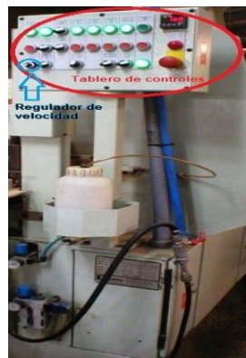
Figura 29. Variador de velocidad Homag
