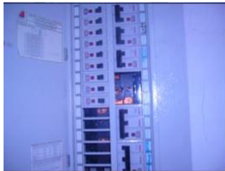
Figura 6. Tablero distribución secundario HT-HP
