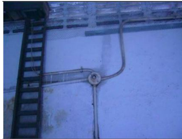
Figura 4. Salida para iluminación de la subestación.
