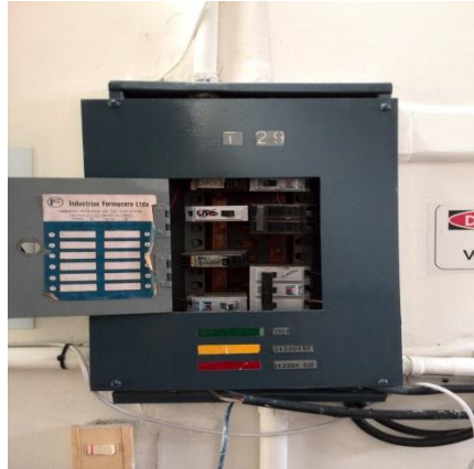
Figura 7. Tablero de distribución secundario Plasma
