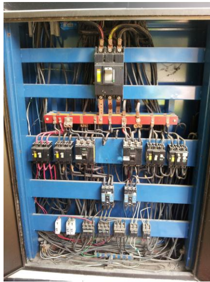
Figura 24. Tablero general de distribución de la C.I.C.
