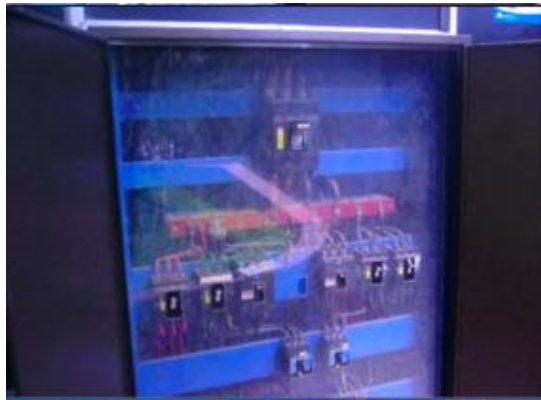
Figura 5. Tablero de distribución principal.
