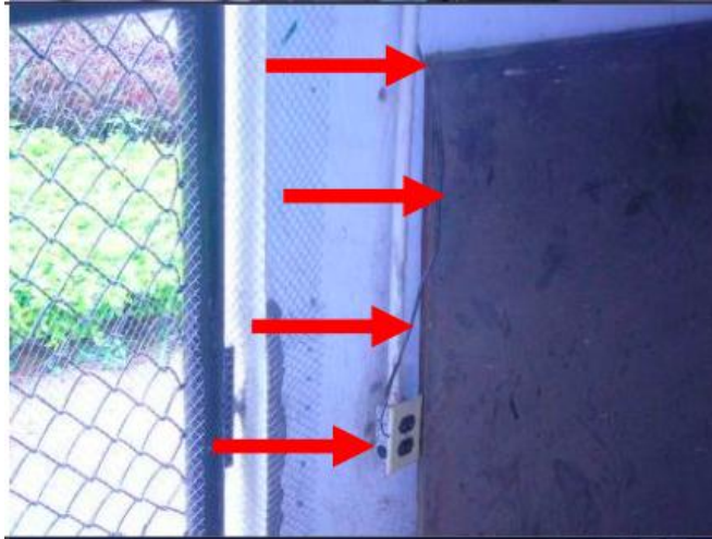
Figura 3. Conductores a la vista al interior de la subestación
