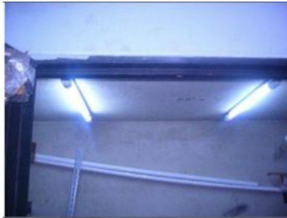
Figura 10. Luminarias laboratorio Electrónica 2.
