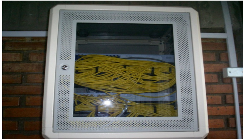
Figura 12. Rack Sala de Computo
