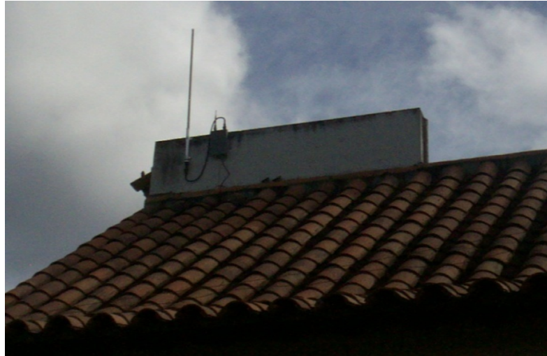
Figura 19. Access Point Anexos Administrativos
