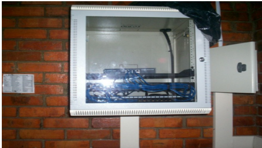
Figura 9. Rack de Mantenimiento
