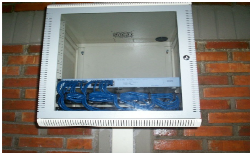
Figura 13. Rack Sala de Computo 6
