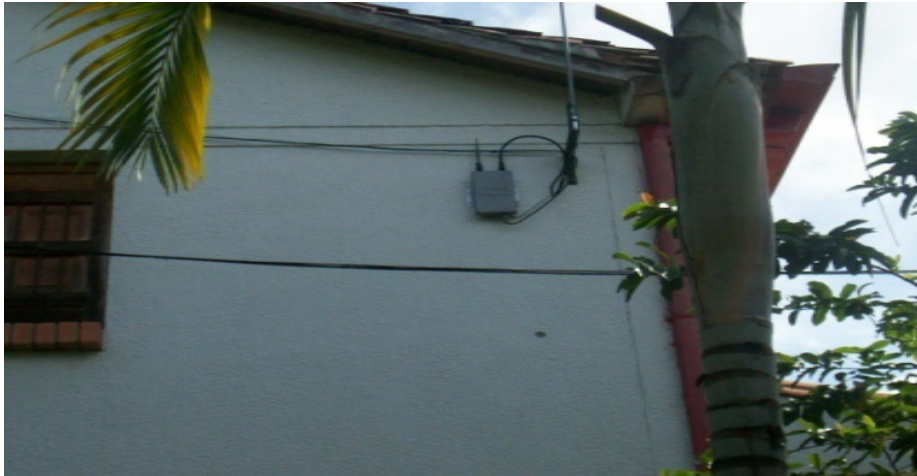
Figura 20. Access Point Casona
