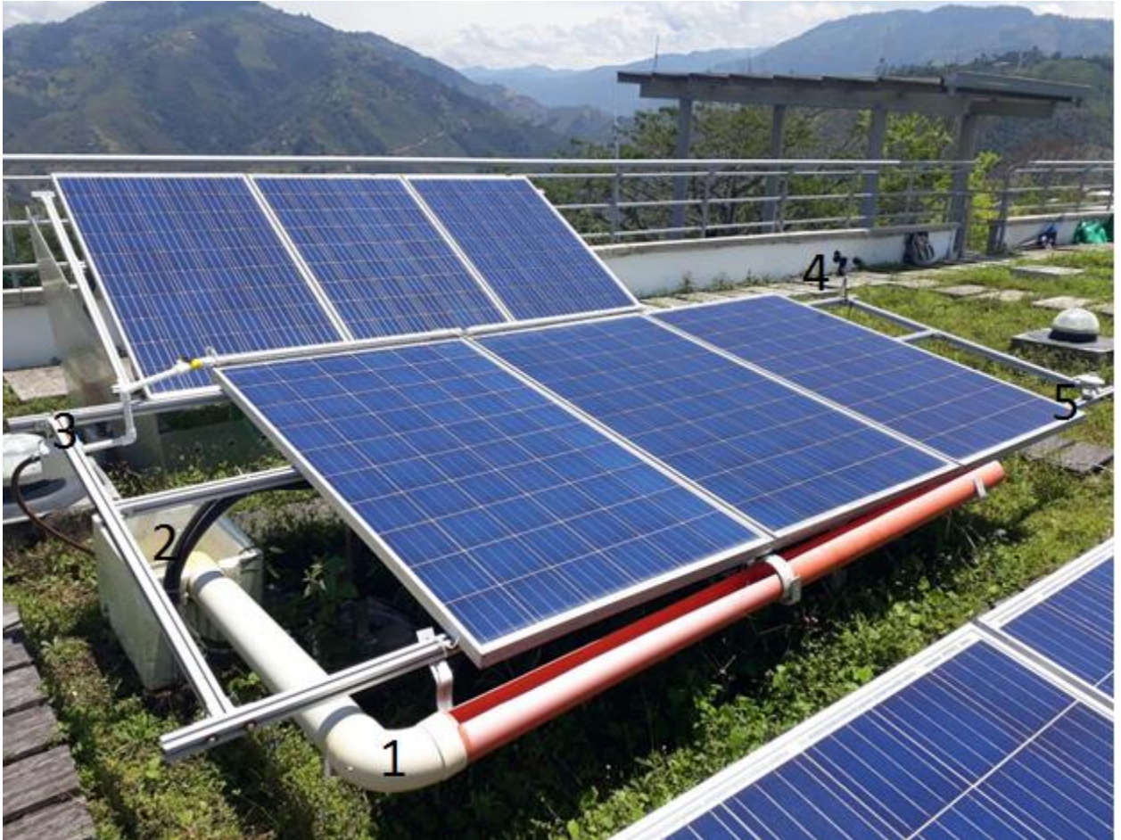
Figura 7. Sistema de irrigación y acopio de agua instalados en paneles FV. 1. Sistema de acopio de agua. 2. Tanque de almacenamiento. 3. Electroválvula del sistema de irrigación. 4. Sensor de viento. 5. Piranómetro.
