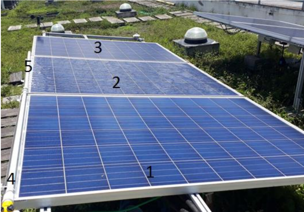
Figura 6. Sistema FV con irrigación en superficie superior. 1. Panel FV operando con técnica de irrigación estática. 2. Panel FV operando con técnica de irrigación predictiva. 3. Panel FV de referencia. 4. Tubería del sistema de irrigación de la técnica estática. 5. Tubería del sistema de irrigación de la técnica predictiva.
